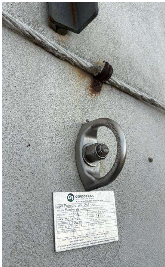
Imagen 6. Punto de anclaje
