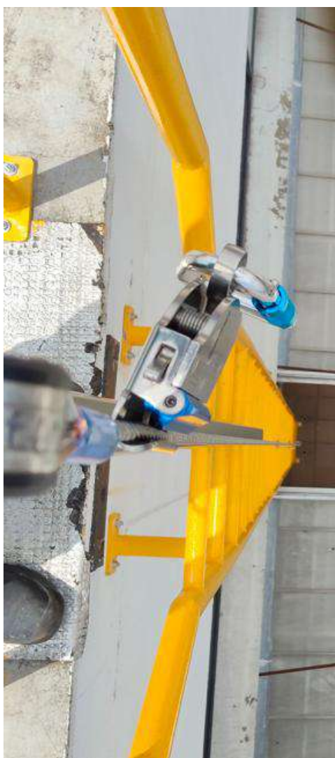
Imagen 4. Línea de vida vertical para Escalera tipo gato cubierta
