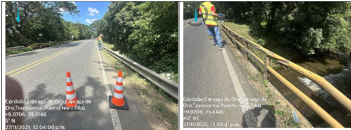
PUENTE CARRANZO I. En Buen estado. Requiere barandas metálicas.
