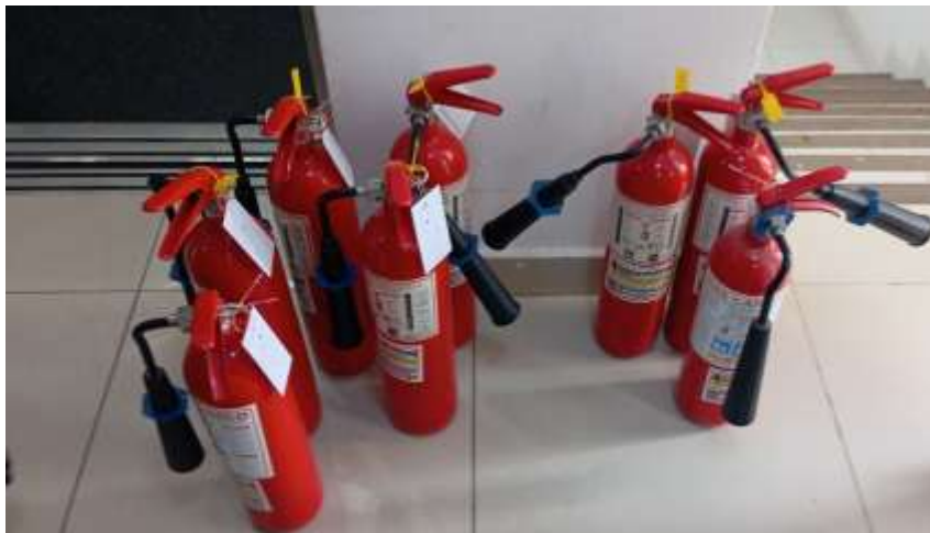
Entrega de extintores para su respectiva recarga
