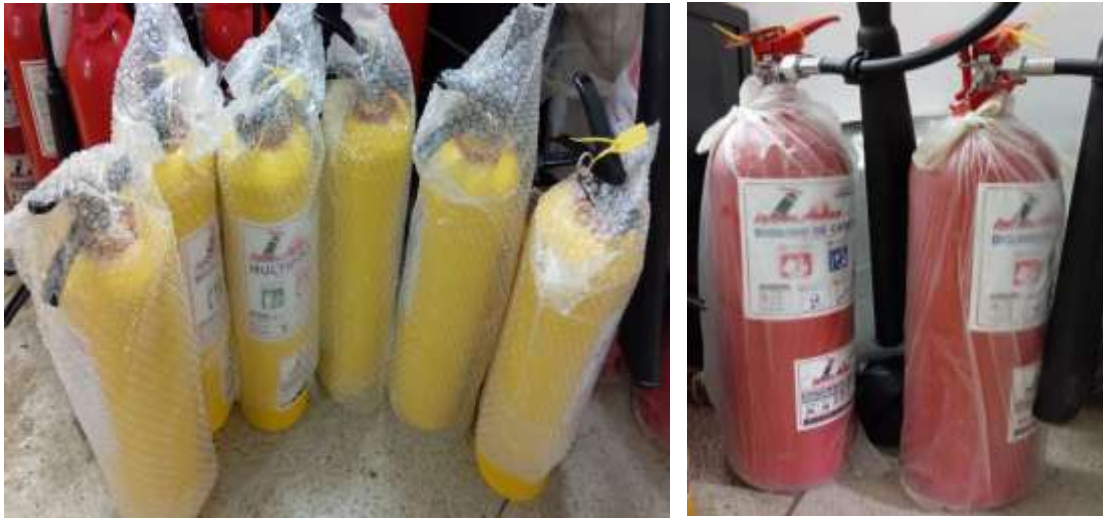
Suministro de extintores 10 lbs tipo ABC y extintores 10lbs CO2
