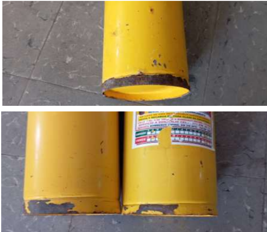
Extintores con deterioro en pintura
