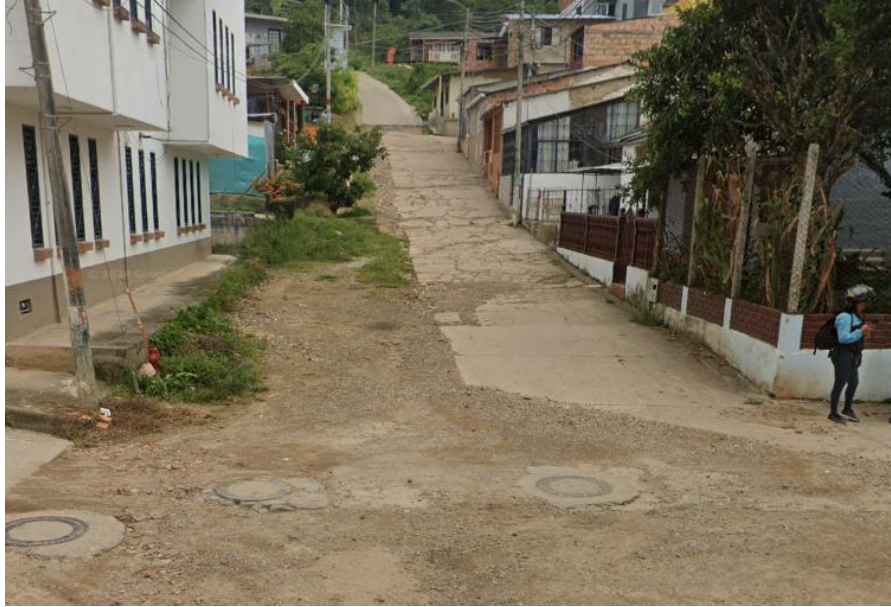
Fotografía 1. Deterioro pavimento rígido carrera 8.
