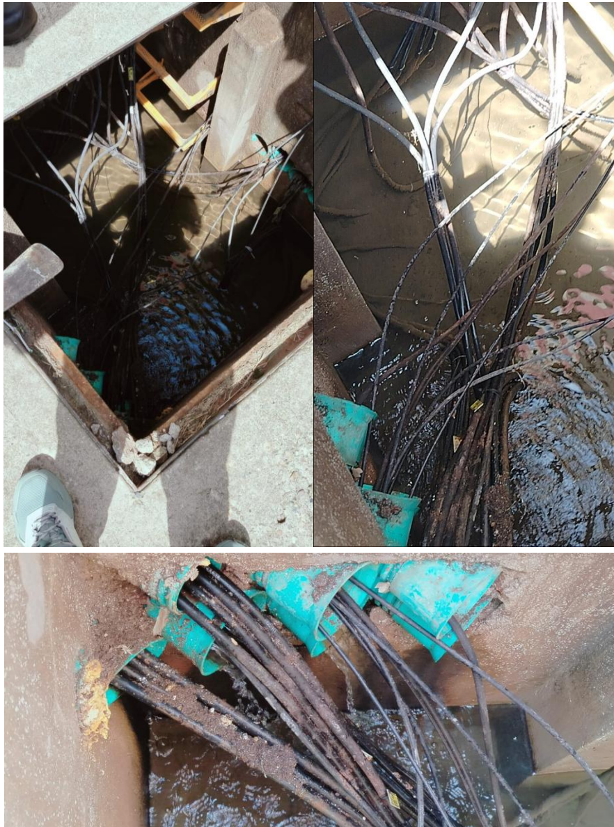
Imagen 3 – fuga representativa en cajas de energía
