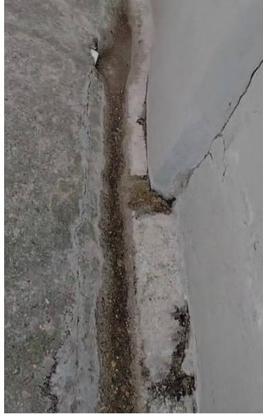
Imagen 1 – fuga en áreas comunes.
