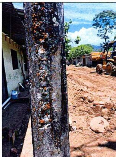
Imagen 1. Evidencia de carbonatación, oxidación y grietas, indicativas del deterioro estructural del poste de alumbrado público
