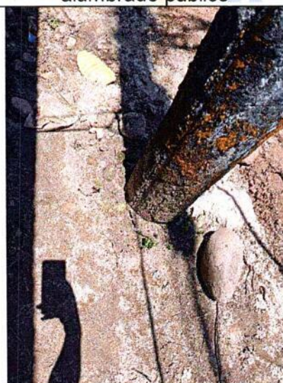
Imagen 3. Compromiso de la estabilidad del terreno debido a la carga del poste y a las labores de excavación manual y mecánica realizadas en el sector
