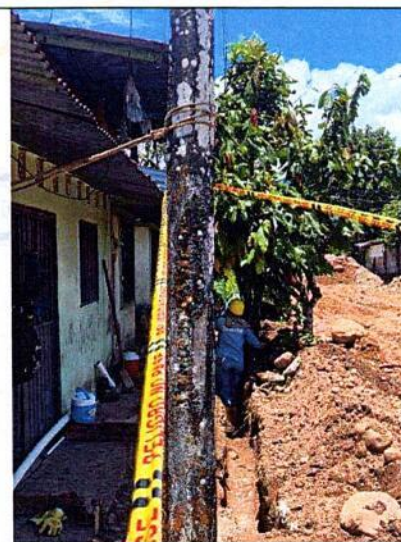
IMAGEN 4. Trabajos de excavación manual en el margen del poste, incrementando el riesgo potencial de colapso de la estructura.
