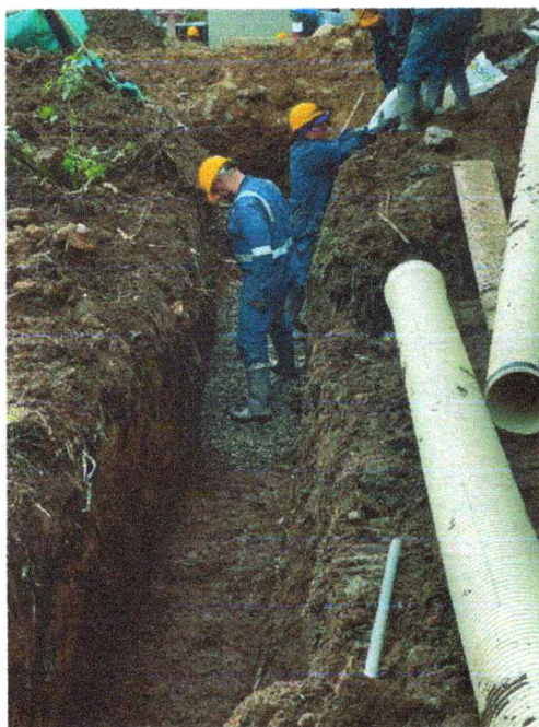
Intalacion de triturado entre la CJ08 A LA CJ010
