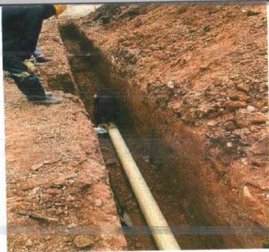
Descripción: Red sanitaria de 8" con silla yee para conexión domiciliaria, Santa Lucía
