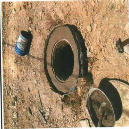
Descripción: Aro y tapa para pozo de inspección, Monserrate Alto
