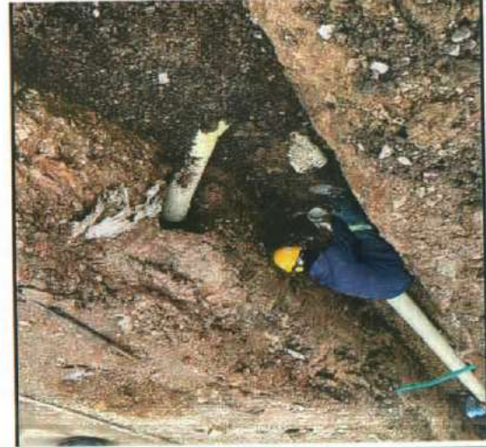
Descripción: Conexión domiciliar a caja de inspección con silla yee, Santa Lucía
