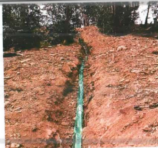
Descripción: Señalización de red de acueducto con cinta verde, Monserrate Alto
