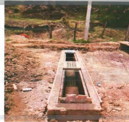
Descripción: Disposición final sumidero Santa Lucía
