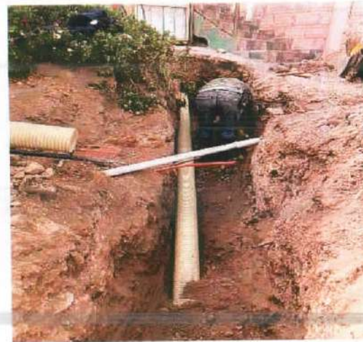
Descripción: Tubería de 6" hacia caja de inspección, Monserrate Alto
