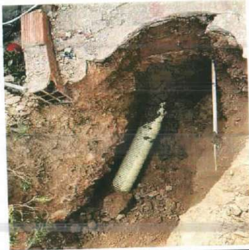
Descripción: Revoque en la entrada del tubo sanitario a caja de inspección, Monserrate Alto
