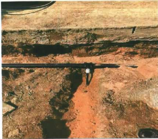
Descripción: Derivación con collarín para conexión a medidor, Monserrate Bajo
