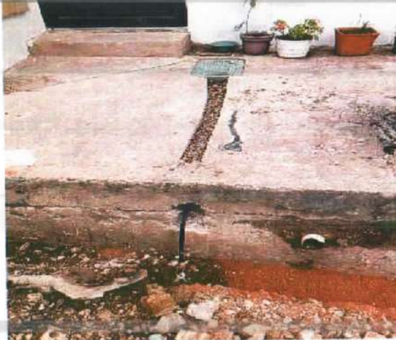
Descripción: Conexión domiciliaria hasta medidor, Villa del sol
