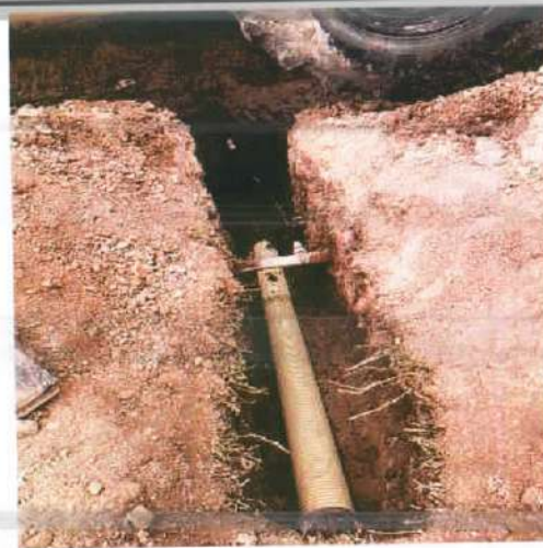
Descripción: Conexión domiciliaria a caja de inspección Monserrate alto
