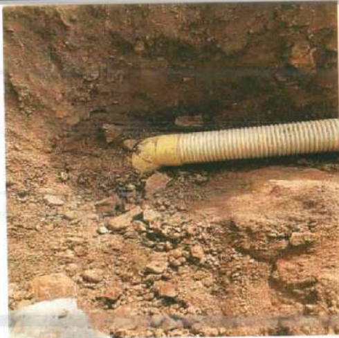
Descripción: Conexión a caja de inspección en tubería de 6" Monserrate Alto
