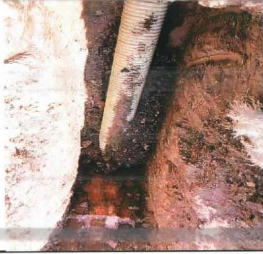
Descripción: Tubería Novafort de 10" en pozo existente con su adecuada pendiente, Prados del Norte
