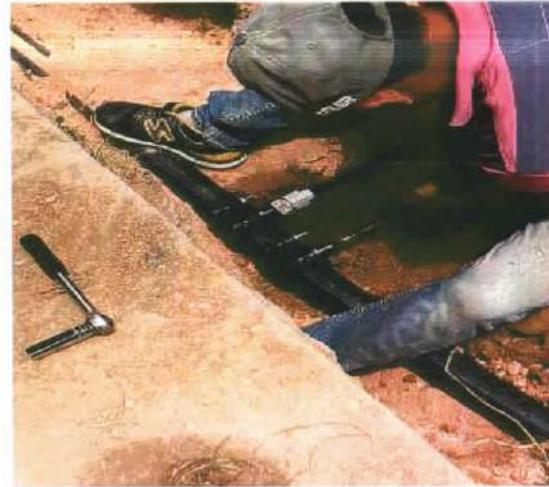
Descripción: Derivación con collarín para conexión a medidor, Monserrate Bajo
