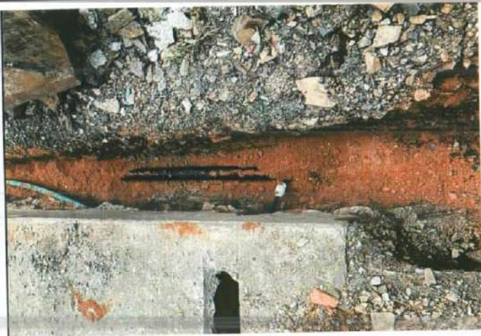
Descripción: Conexión domiciliaria hasta medidor, Villa del sol
