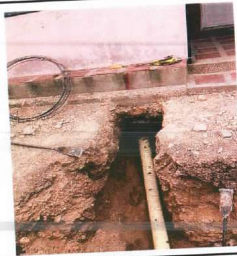
Descripción: Conexión a caja domiciliaria Monserrate Alto
