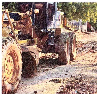
Ilustración 8. Afectaciones por lluvias.
