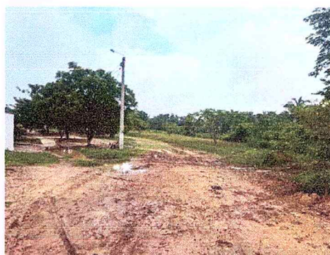
Ilustración 9. Afectaciones por lluvias.
