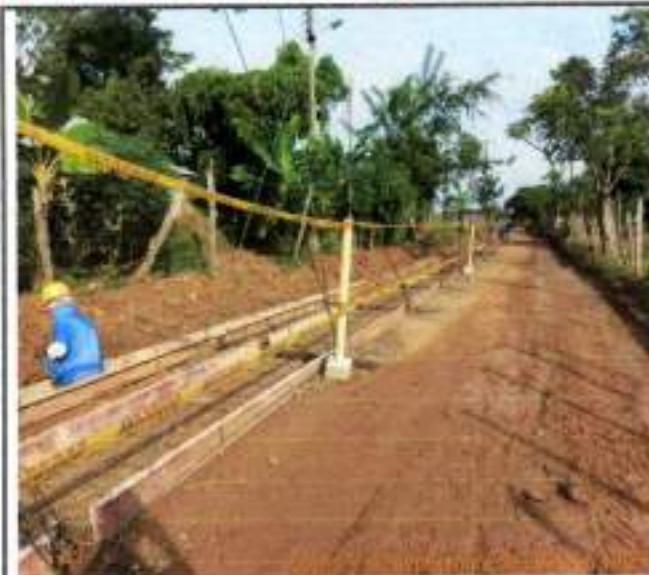
Foto GSST1. Evidencia de barrera en zona restringida por el SGSST
