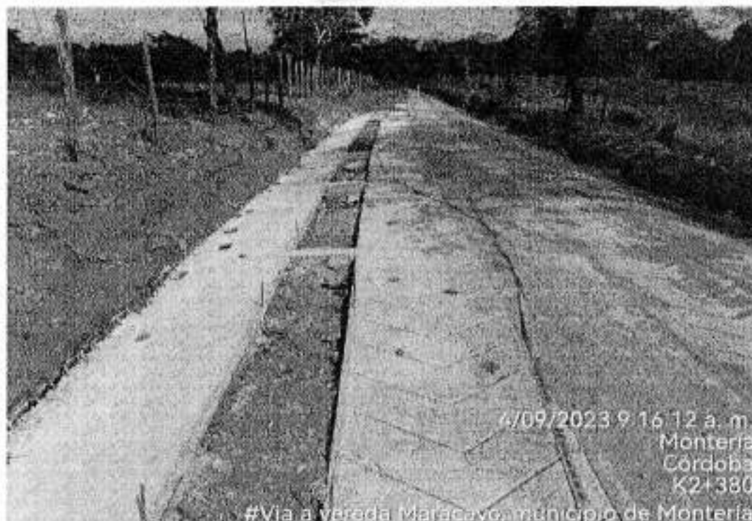
Fotografía N°07. Se evidencia piedra pegada sin fundir
