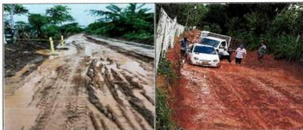
Mejoramientos a lo largo del tramo vial debido al pésimo estado de la vía por las lluvias
