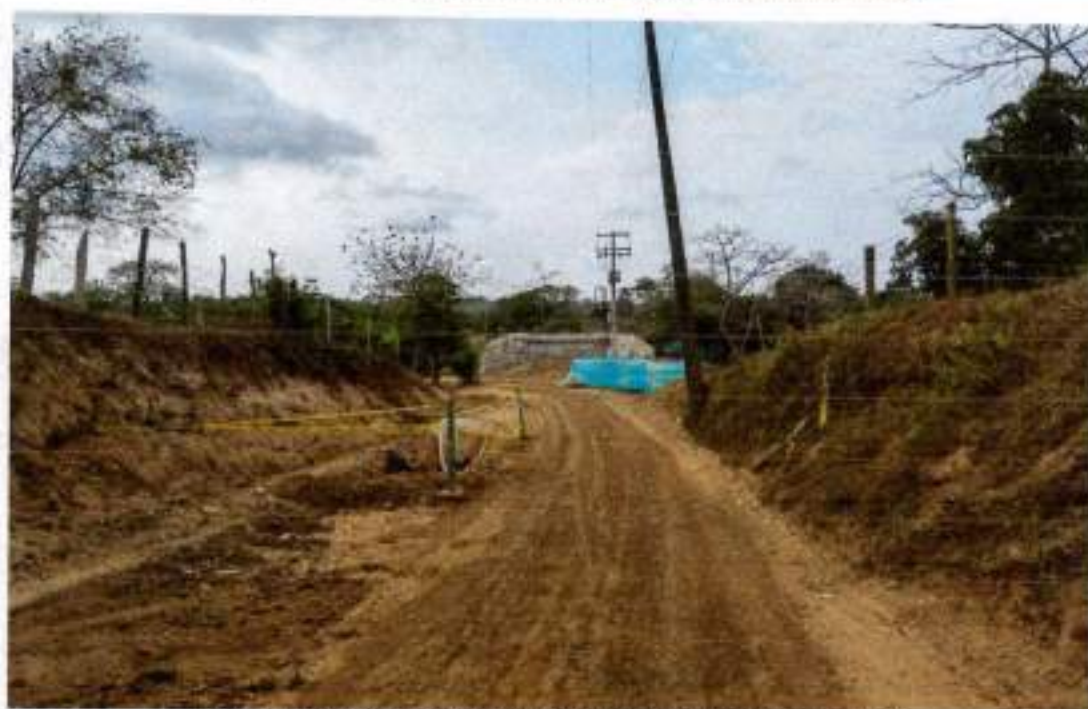
Fotografia 2. Se evidencia Poste de energía en abcisa k1+770
