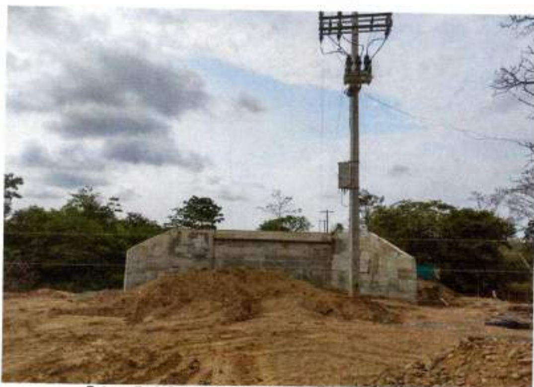
Fotografia 1. Se evidencia Poste de energía en abcisa k1+740
