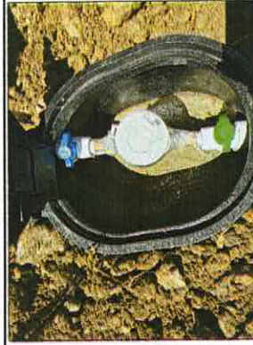
Foto 3: SUMINISTRO E INSTAL. MICROMEDIDOR DE VELOCIDAD TRANS. MECANICA. CUERPO METALICO. - CHORRO UNICO CLASE C 1/2" R160 (INC. CERTIFICADO CALIBRACION Y ACOPLES)
