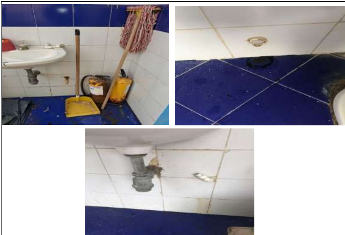
Foto1: se evidencia que las unidades sanitarias no tienen acceso al agua y algunas estas desconectadas y no tienen los accesorios para el flujo del agua.
