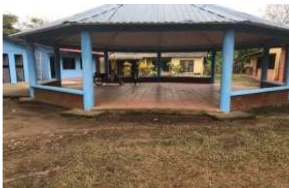
Foto 1: se puede evidenciar que el kiosco escolar esta sucio y descolorido, la pintura existente es de un tono amarillo donde en partes se evidencia la humedad.
