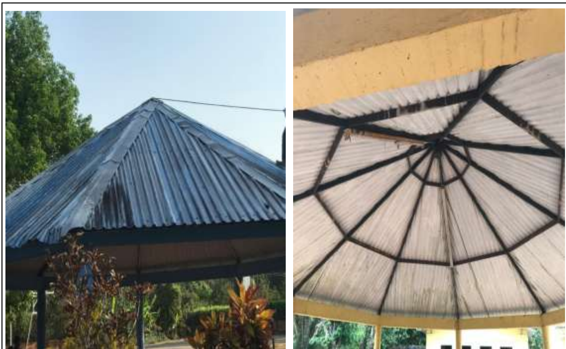
Foto 1: en las imágenes mostradas se puede evidenciar con claridad el estado del techo y lo sucio que estan, igual que los perfiles, el cual requiere de limpieza y pintura.
