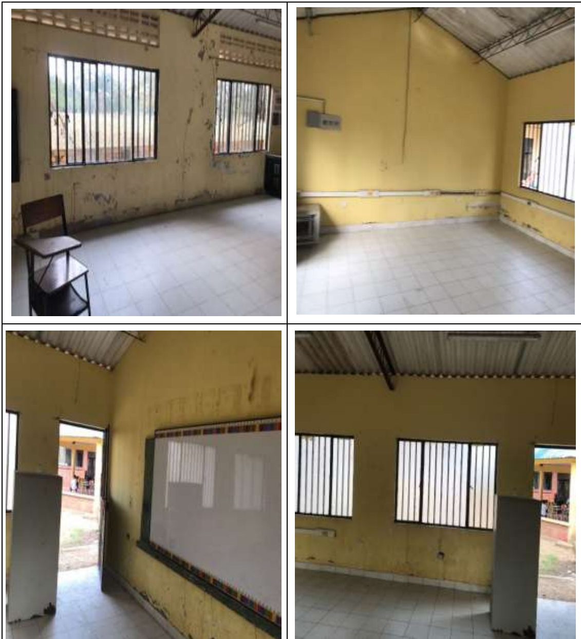
Foto 1: se puede evidenciar en las fotos el deterioro de las paredes en el antes de intervenirlas, como se nota que la pintura esta soplada por la humedad y en algunas partes ya está podrida.
