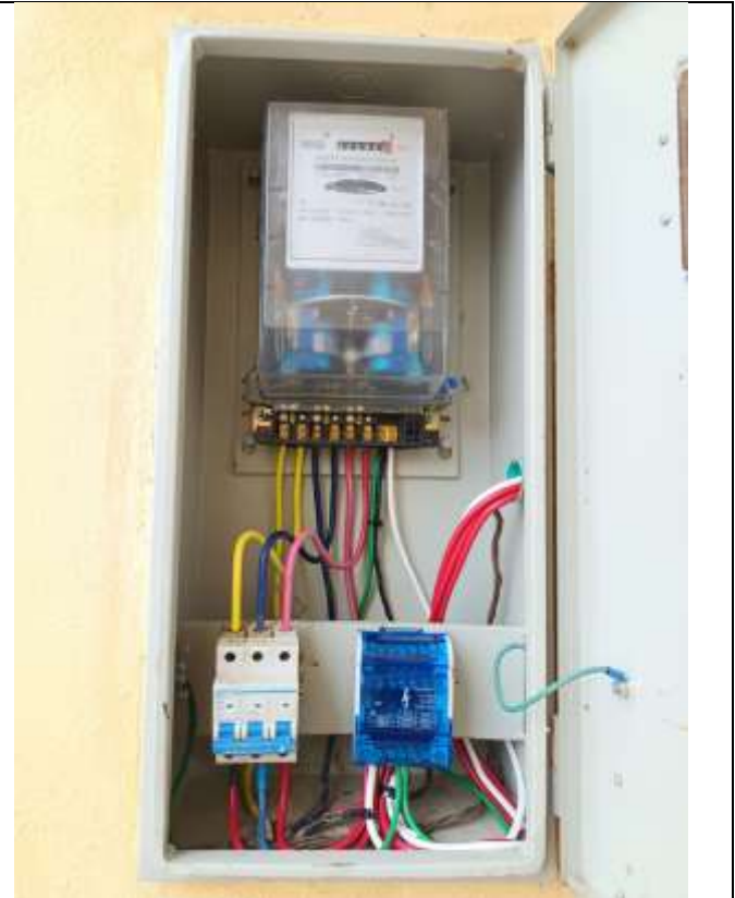
Foto 2: Estado Final caja industrial con medidor, barrajes y breaker
