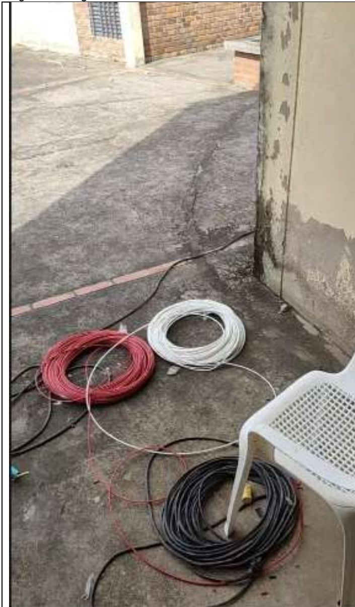
Foto 1: Estado inicial Alambre de Cobre THWN N° 12 AWG
