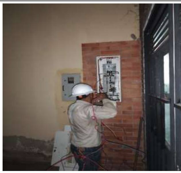
Foto 2: Estado Final Alambre de Cobre THWN N° 14 AWG
