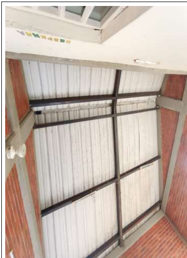
Foto 1: Estado inicial de iluminarias
