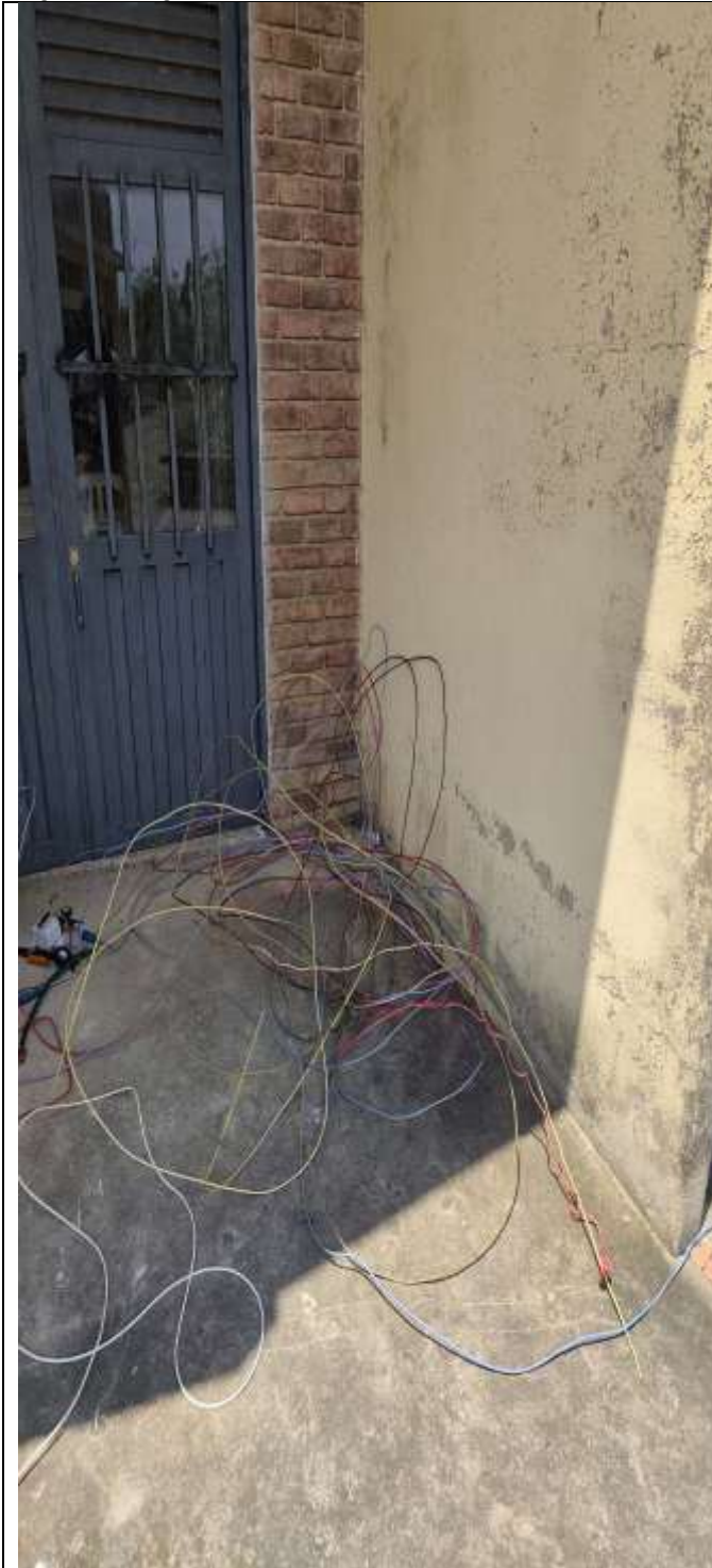
Foto 1: Estado inicial Alambre de Cobre THWN N° 14 AWG
