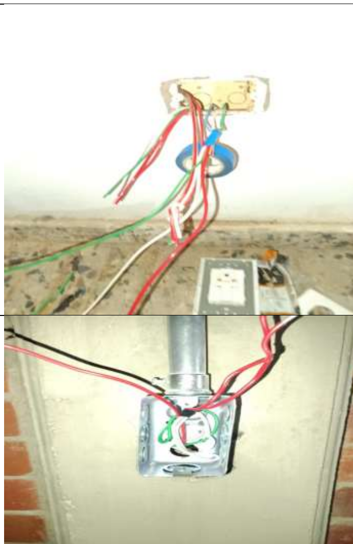
Foto 2: Estado Final Alambre de Cobre THWN N° 14 AWG
