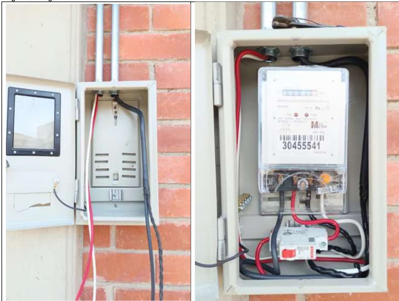
Foto 1: Estado inicial donde se Breaker 1 x 63 Amp
