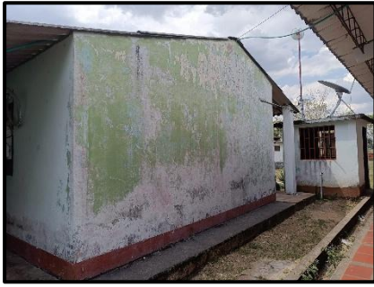
Foto 1: Pintura existente de los Muros de las zonas comunes (Pasillos) de la Escuela La Venturosa.
