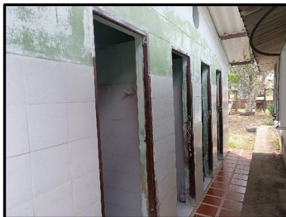
Foto 1: Pintura existente de los Muros de las Baterías Sanitarias de la Escuela La Venturosa.
