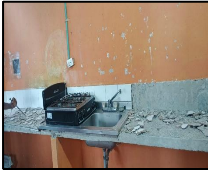
Foto 1: Pintura existente de los Muros de las zonas comunes (Cocina Escolar) de la Escuela La Venturosa.
