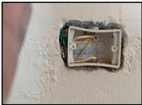
Foto 1: Puntos Eléctricos localizados en el Salón de Clases.
