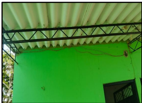
Foto 1: Puntos Eléctricos localizados en la parte exterior del Salón de Clases.
