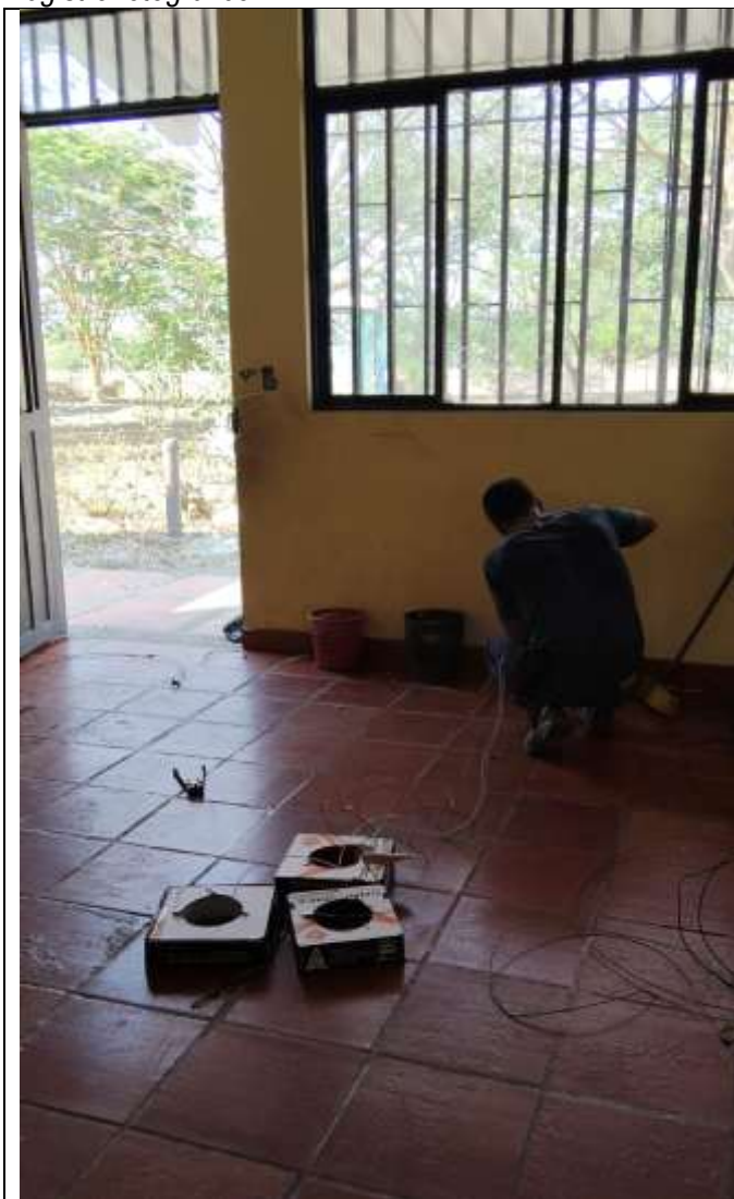
Foto 1: Estado Inicial de instalación de cobre THWN N°12 AWG, color blanco
