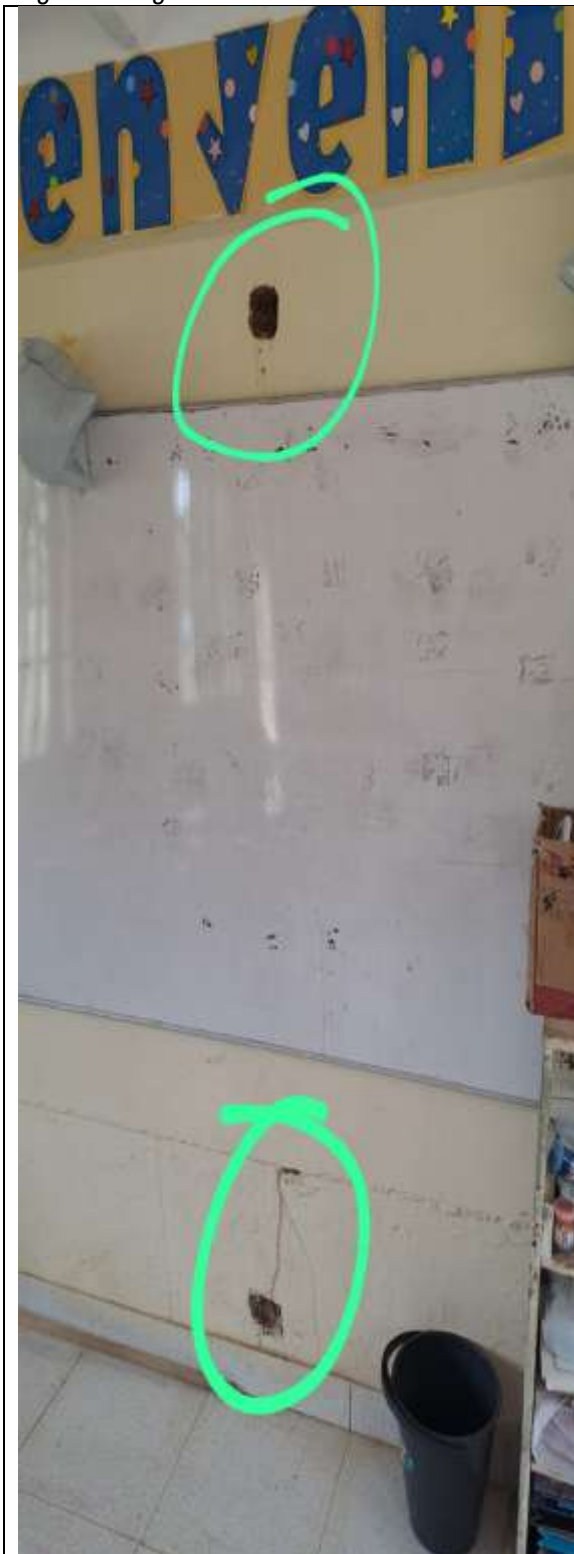
Foto 1: Estado Inicial Salida de iluminación y toma corriente
