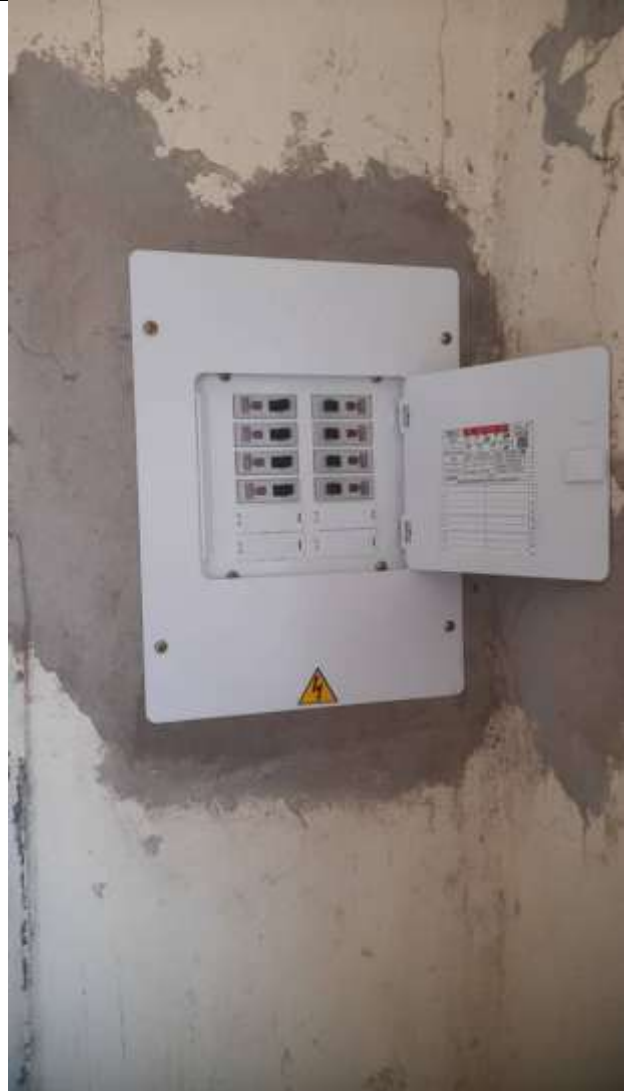
Foto 2: caja de 6 circuitos bifásica
