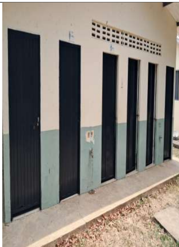
Foto 2: Estado final de las puertas de los baños
