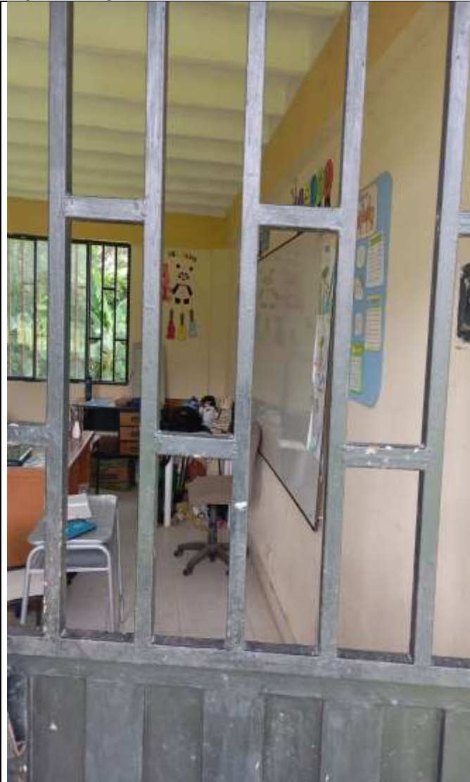
Foto 1: Estado Inicial de puerta
