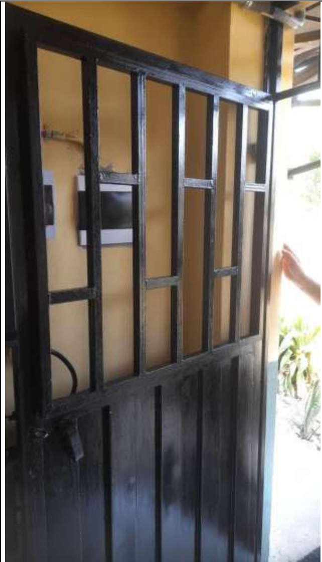
Foto 2: Estado final de puerta .
