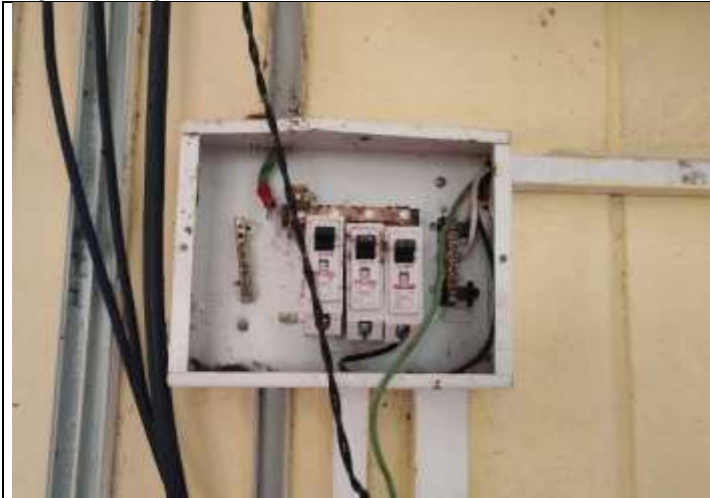
Foto 1: Estado Inicial de los breaker
