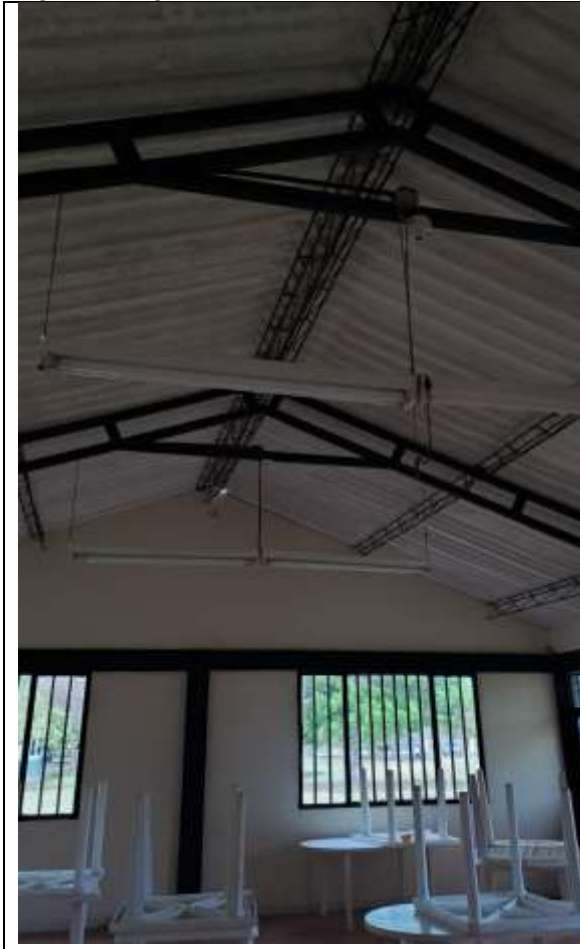
Foto 1: Estado Inicial Iluminarias
