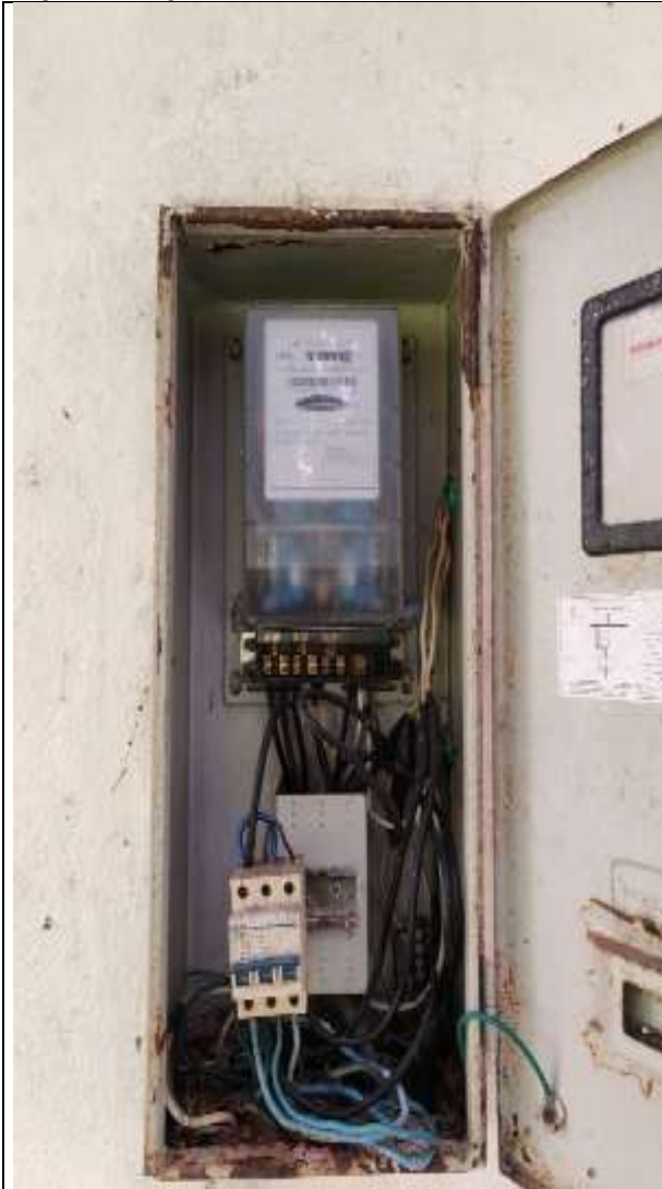
Foto 1: instalación inicial de breaker 2 x 63 Amp.
