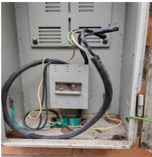
Foto 1: Estado Inicial sin breaker
