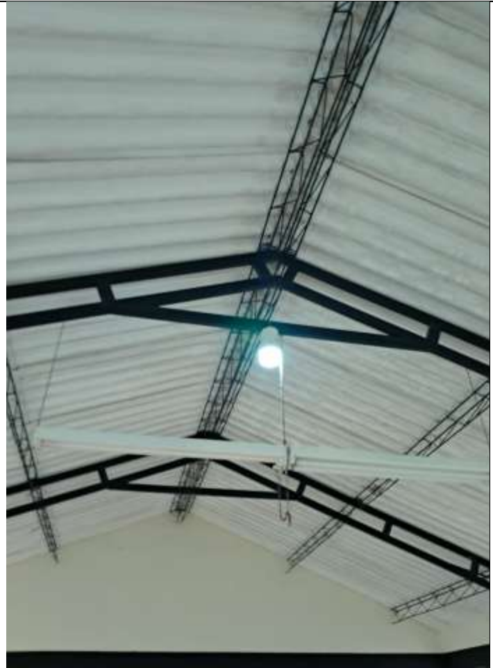
Foto 2: Estado Final Iluminarias
