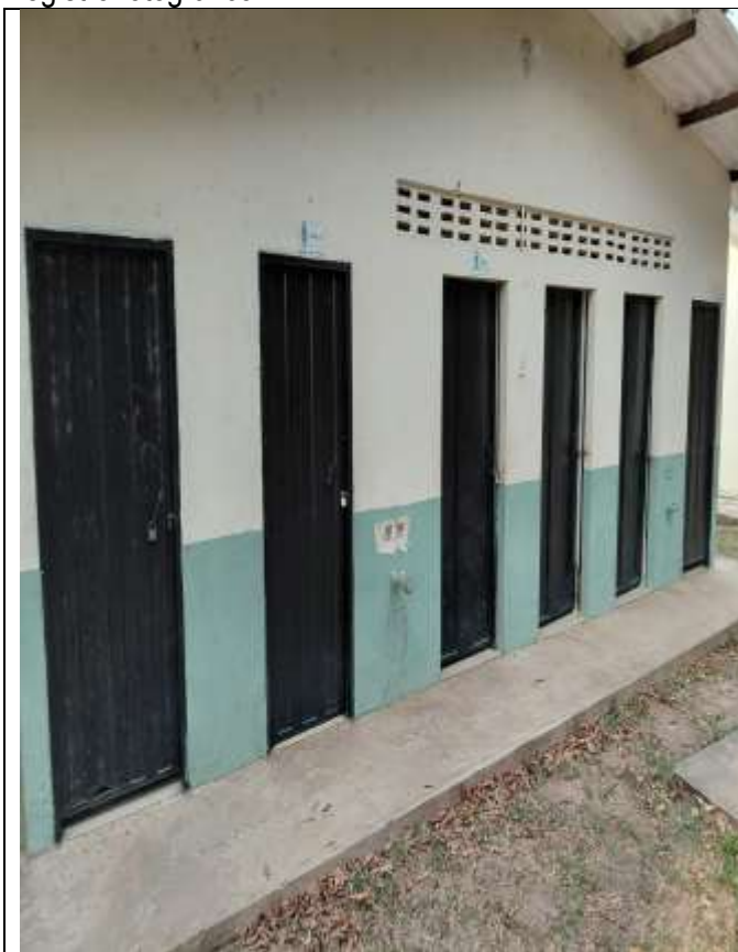
Foto 1: Estado Inicial de puertas de los baños
