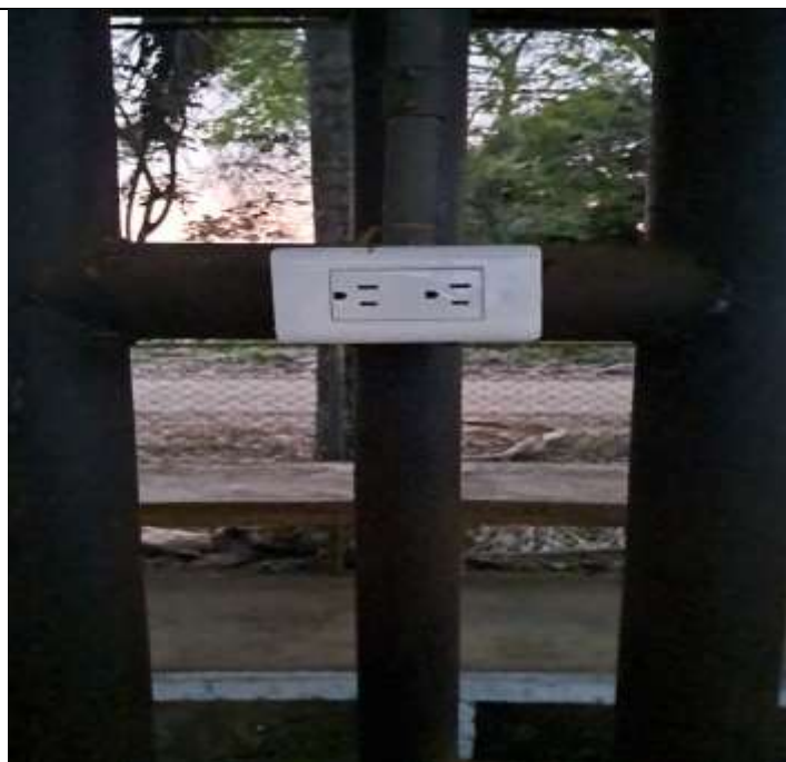
Foto 2: Estado Final punto eléctrico
