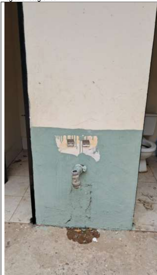
Foto 1: Estado Inicial de conexión
