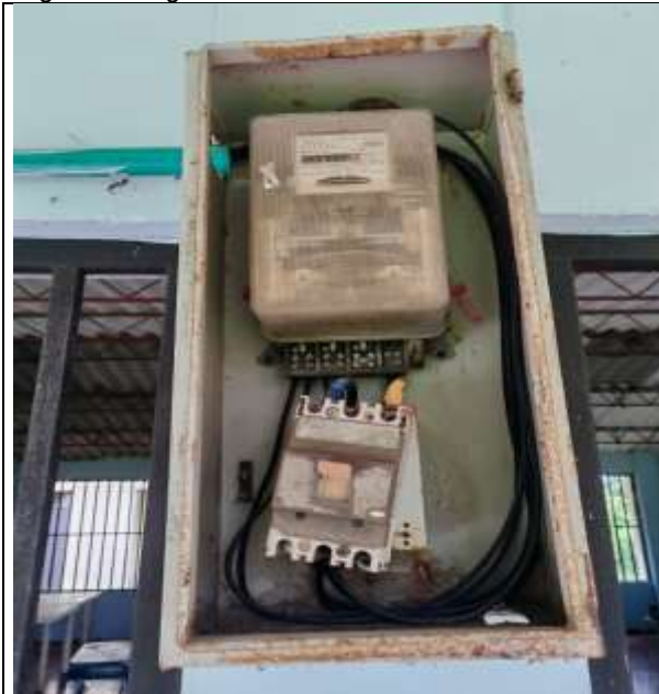
Foto 1: Estado inicial caja
