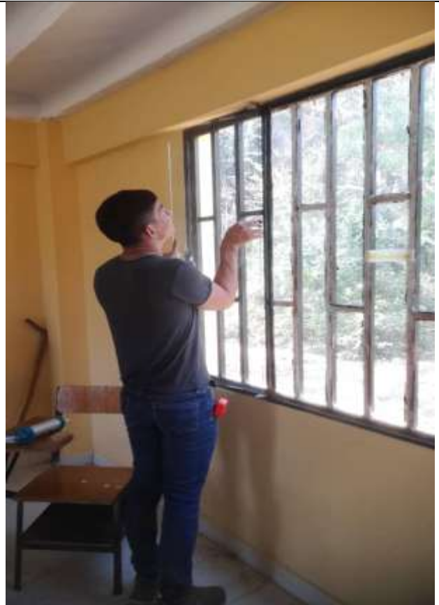
Foto 2: Estado final de las ventanas
