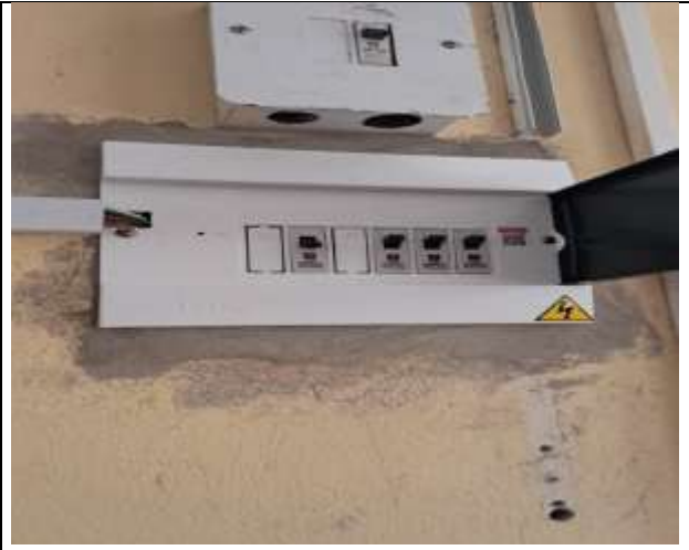
Foto 2: instalación de breaker
