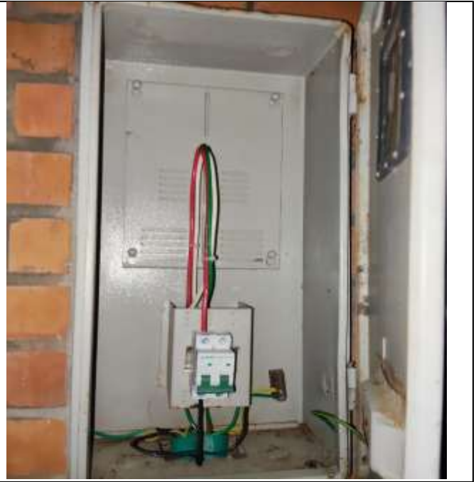
Foto 2: cable 8 AWG cobre de color blanco instalado
