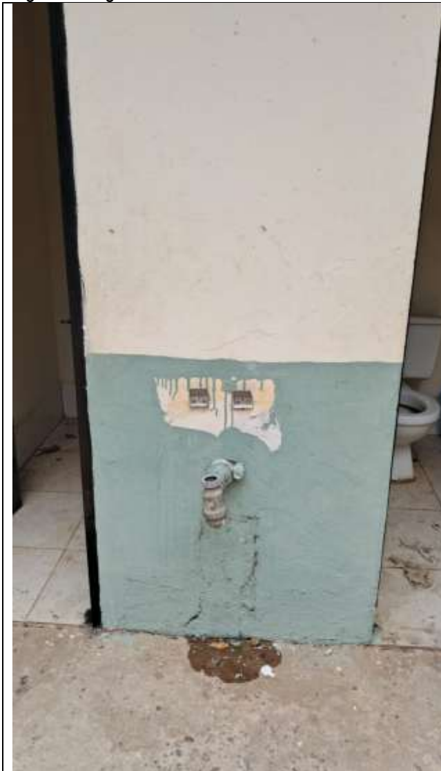
Foto 1: Estado Inicial conexión lavamanos
