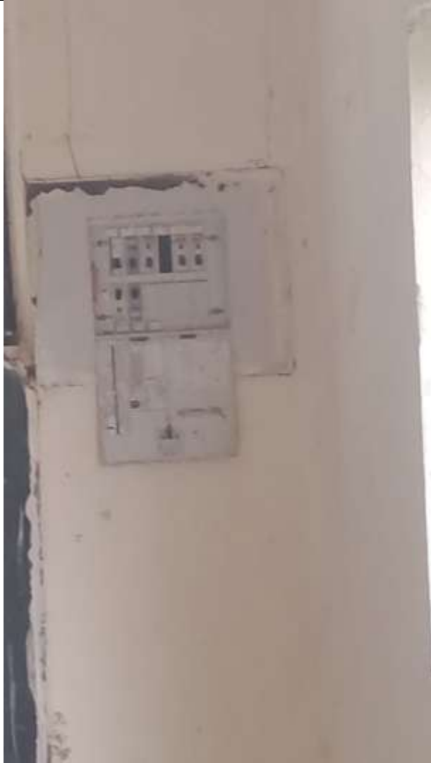
Foto 1: tablero de 6 circuitos antes
