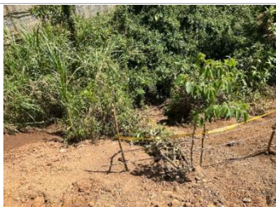
PR98+800 Ruta 6002 - DISPOSICIÓN DE MATERIAL DE EXCAVACIÓN SOBRE FUENTE HÍDRICA
