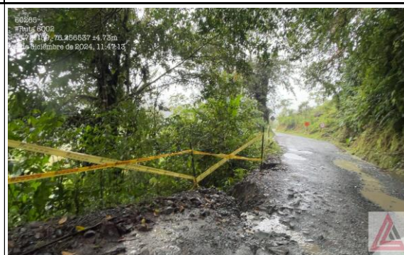
PR60+265 RUTA 6002, SITIO CRÍTICO POR PÉRDIDA DE BANCA.
