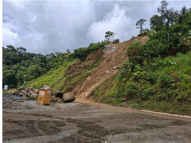
Figura 3. PR 43+762 Ruta 6002, Olaya Uno Estabilización de ladera izquierda.
