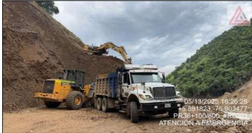
Imagen 1. Emergencia en Pr36_R6003 por inestabilidad de laderas.
