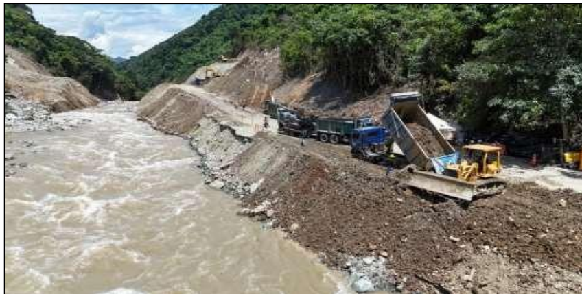
Imagen 2. Emergencia en Pr36_R6003 por Deslizamiento de laderas.
