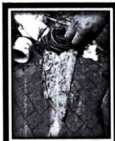
Detalle elemento de madera altamente
