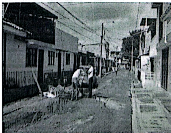
Condiciones iniciales de la vía
