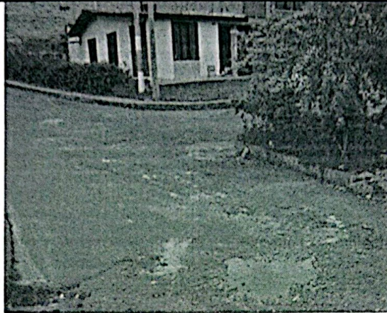
Condiciones iniciales de la vía
