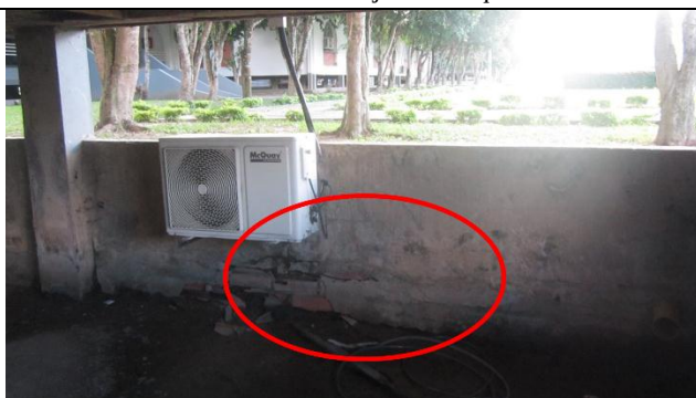
FOTOGRAFIA no 160. Muro de ladrillo en arcilla con grietas, fisuras y humedades - bloque administrativo.
