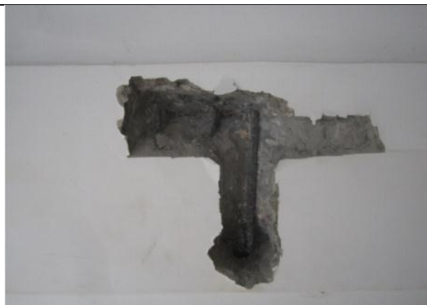
FOTOGRAFIA no. 21. Regata viga eje G 7i-6i piso 1 zona administrativa.
