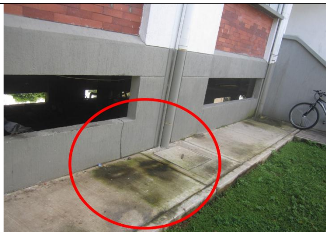
FOTOGRAFIA No 177. Humedades y eflorescencias - bloque de patrulleros.
