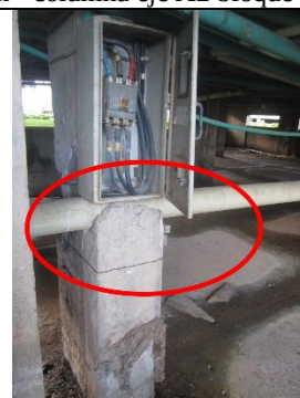
FOTOGRAFIA no 161. Perdida de sección por paso de tuberías y esprendimiento del concreto - columna eje E4 bloque administrativo.
