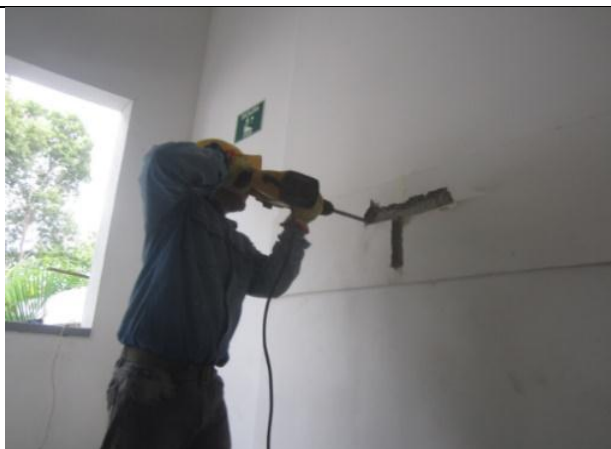
FOTOGRAFIA no. 20. Regata viga eje G 7i-6i piso 1 zona administrativa.
