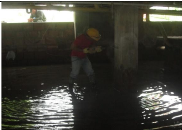
FOTOGRAFIA no. 39. Regata Columna eje B4 semisótano bloque de patrulleros.
