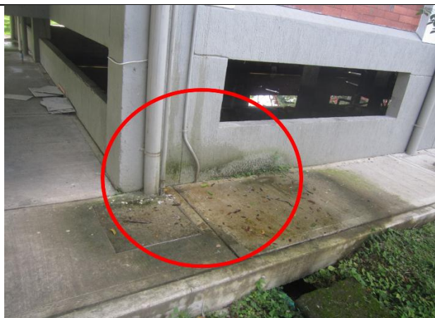
FOTOGRAFIA No 176. Humedades y eflorescencias - bloque de patrulleros.
