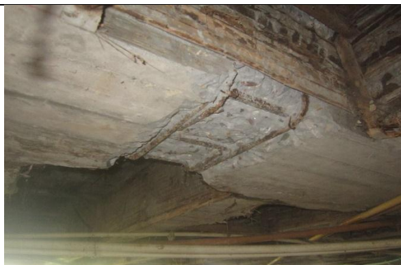
FOTOGRAFIA no 8. Regata en viga aérea semisótano eje 5 B-C zona administrativa 2.
