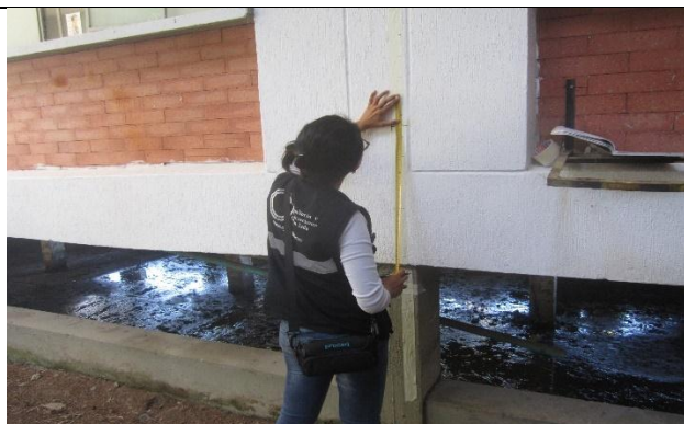
FOTOGRAFIA no 122. Ensayo de detección magnética ferrosca en columna eje G-8I piso 1 sanidad.
