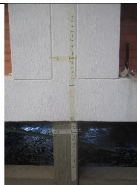
FOTOGRAFIA no. 123. Ensayo de detección magnética ferrosca en columna eje G-8I piso 1 sanidad.
