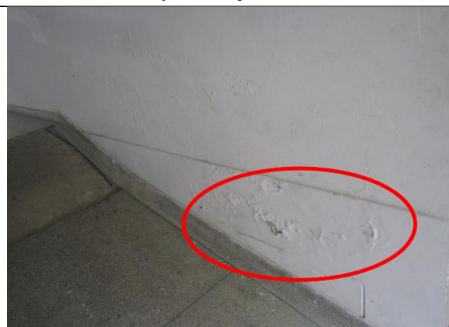
FOTOGRAFIA No 169. Daños por humedad y desprendimientos de pintura.
