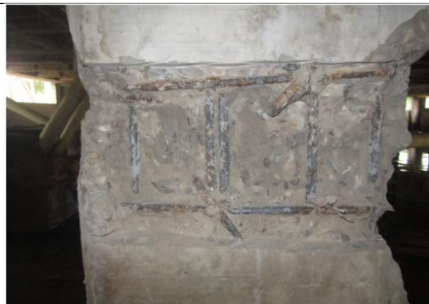
FOTOGRAFIA no. 40. Regata Columna eje B4 semisótano bloque de patrulleros.
