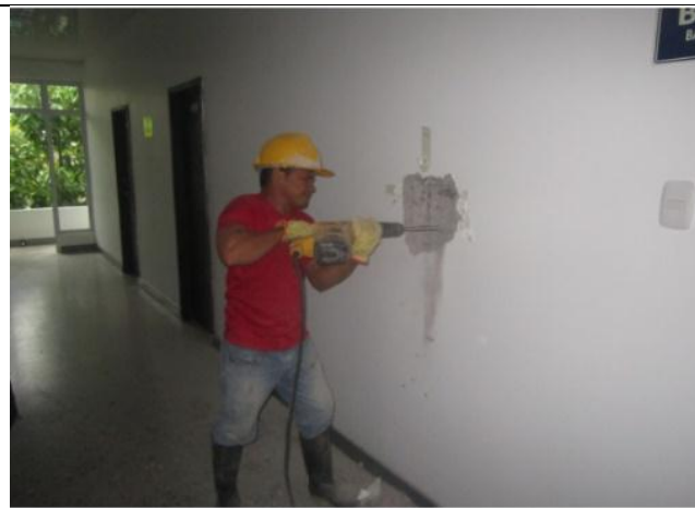
FOTOGRAFIA no. 44. Regata Columna eje B3 piso 2 bloque de patrulleros.
