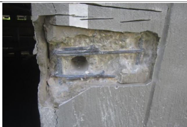
FOTOGRAFIA no. 32. Regata Columna eje I6 semisótano bloque de oficiales.
