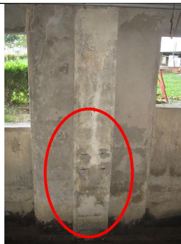
FOTOGRAFIA no. 157. Desprendimiento del concreto y acero con corrosión - columna eje A4 bloque administrativo.
