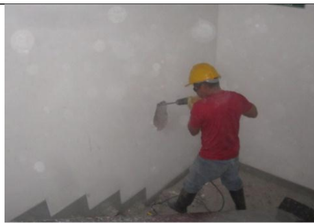
FOTOGRAFIA no. 42. Regata Viga eje B 5-6 piso 2 bloque de patrulleros.
