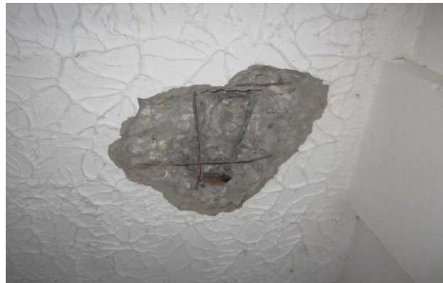
FOTOGRAFIA no 13. Regata viga de entrepiso eje 2 G-H zona administrativa 1 piso 2.
