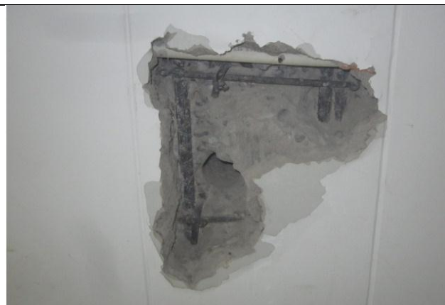
FOTOGRAFIA no. 24. Regata columna eje C10 piso 1 bloque de oficiales.
