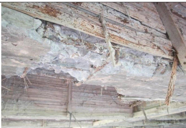
FOTOGRAFIA no 10. Regata viga semisótano eje H 4I-3I. Zona administrativa 1.
