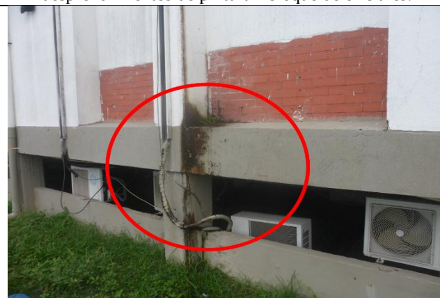
FOTOGRAFIA No 175. Daños por humedad y eflorescencias - bloque de oficiales.
