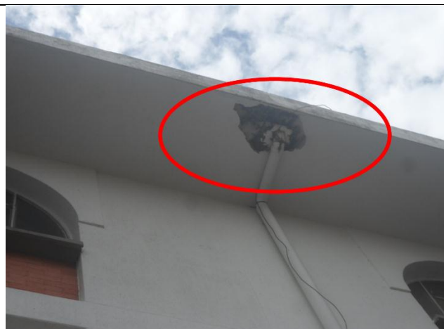
FOTOGRAFIA No 171. Daños por humedad y desprendimientos de pintura bloque administrativo.
