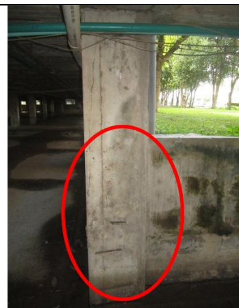
FOTOGRAFIA no 165. Desprendimiento del concreto y acero con corrosión - columna eje G3 bloque administrativo.
