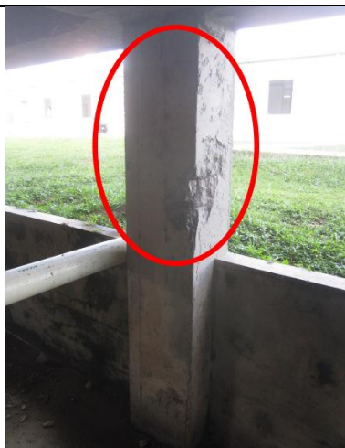
FOTOGRAFIA no. 154. Fisuras, desprendimiento del concreto y acero con corrosión - columna eje B9 bloque administrativo.
