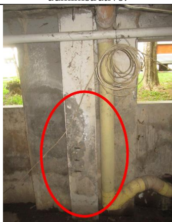
FOTOGRAFIA No. 168. Acero corroídos y desprendimiento del concreto - columna eje G0 bloque administrativo.
