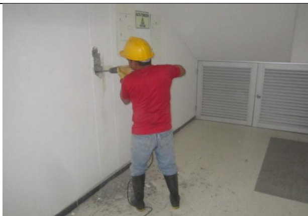
FOTOGRAFIA no. 23. Regata columna eje C10 piso 1 bloque de oficiales.
