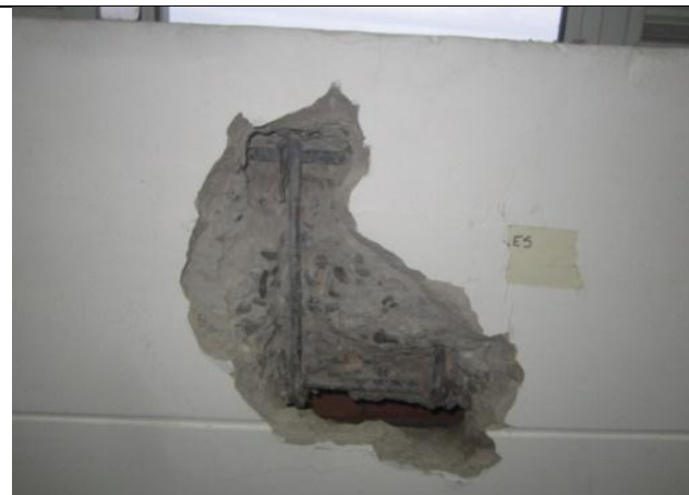
FOTOGRAFIA no. 28. Regata Viga eje B 10-11 piso 2 bloque de oficiales.
