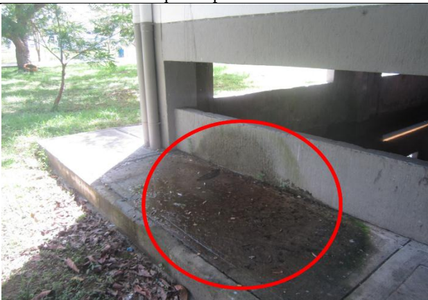
FOTOGRAFIA No 178. Humedades y eflorescencias - bloque de patrulleros.
