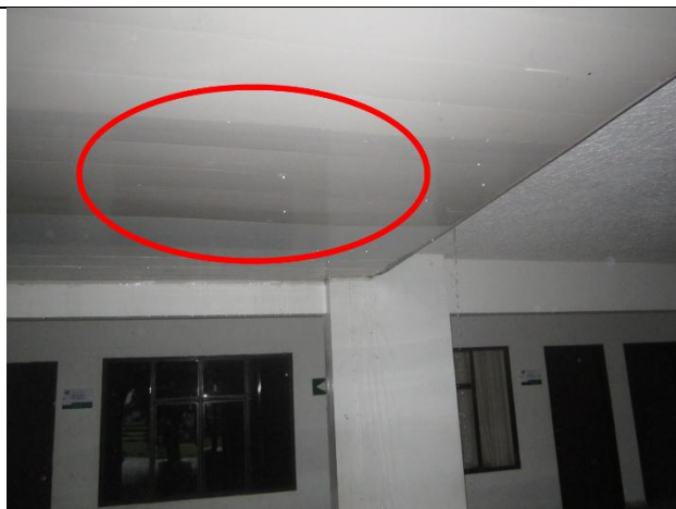
FOTOGRAFIA No 170. Filtraciones en cielorraso producto de rebosamiento en viga canal - zona administrativa 1 primer piso.
