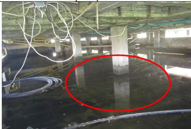
FOTOGRAFIA No 179. Inundación en sótanos - bloque de patrulleros.
