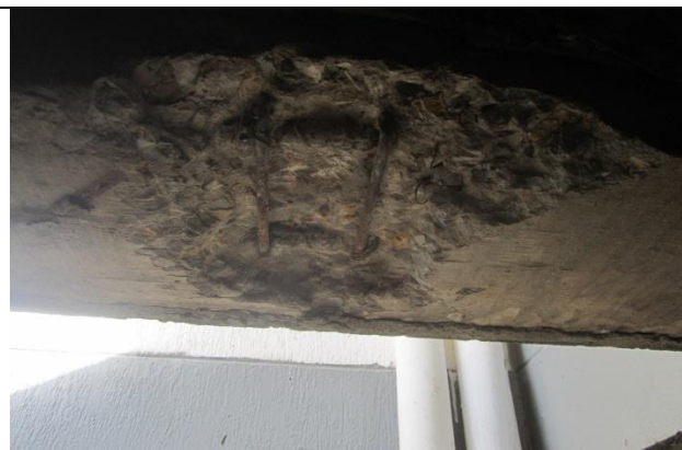
FOTOGRAFIA no 11. Regata viga semisótano eje I 3I-2I. Zona administrativa 1.
