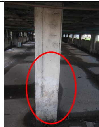
FOTOGRAFIA no 167. Humedad y eflorescencias - columna eje H4 bloque administrativo.
