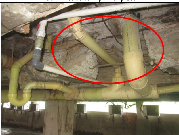
FOTOGRAFIA No 172. Lesión por paso de tuberías en vigas de entrepiso - Bloque de oficiales.
