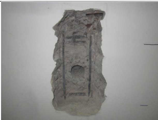
FOTOGRAFIA no. 43. Regata Viga eje B 5-6 piso 2 bloque de patrulleros.
