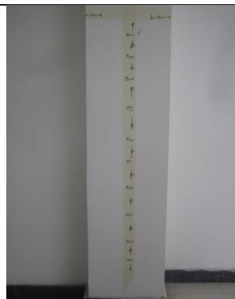
FOTOGRAFIA no. 144. Ensayo de detección magnética ferroscaan Columna Eje D8 piso 2 bloque de oficiales.
