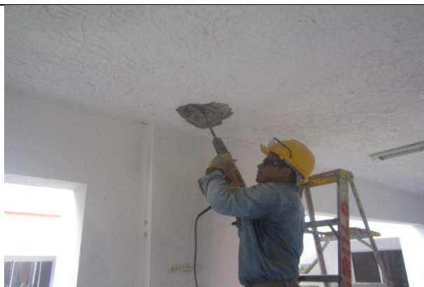
FOTOGRAFIA no 14. Regata viga de entrepiso eje 2 G-H zona administrativa 1 piso 2.
