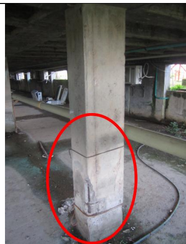
FOTOGRAFIA no. 155. Desprendimiento del concreto y acero con corrosión - columna eje B8 bloque administrativo.
