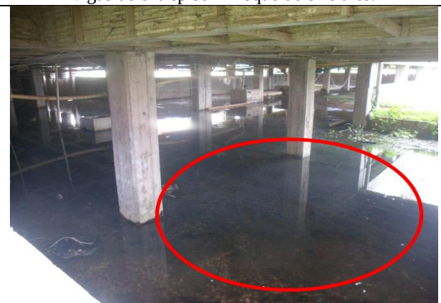
FOTOGRAFIA No 174. Inundación en sótanos - bloque de oficiales.
