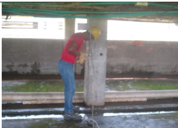
FOTOGRAFIA no. 35. Regata Columna eje C7 semisótano bloque de oficiales.
