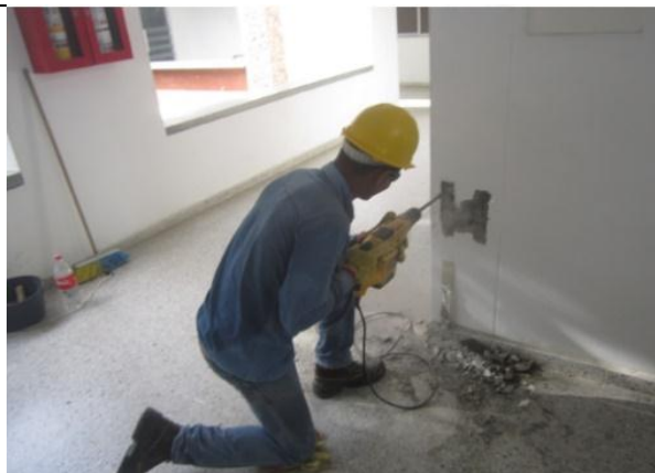
FOTOGRAFIA no 16. Regata Columna eje E4 piso 2 zona administrativa 1.
