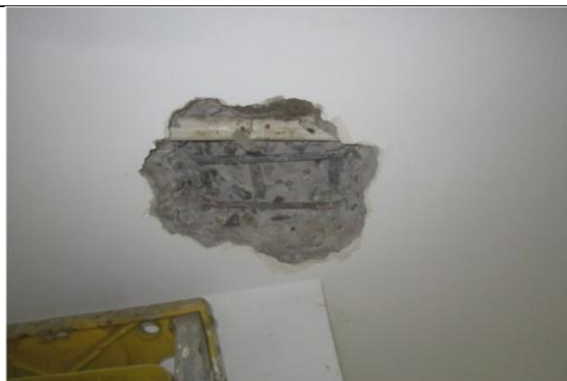
FOTOGRAFIA no. 26. Regata Viga entrepiso 2 eje D 9-10 bloque de oficiales.
