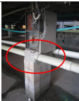
FOTOGRAFIA No. 162 Perdida de sección por paso de tuberías y desprendimiento del concreto - columna eje F4 bloque administrativo.
