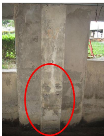
FOTOGRAFIA no. 156. Desprendimiento del concreto y acero con corrosión - columna eje c6 bloque administrativo.
