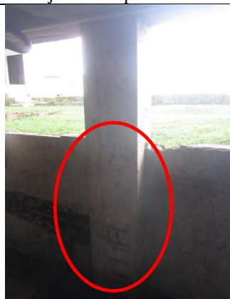
FOTOGRAFIA no 166. Desprendimiento del concreto y acero con corrosión - columna eje G5 bloque administrativo.
