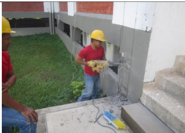
FOTOGRAFIA no. 31. Regata Columna eje I6 semisótano bloque de oficiales.
