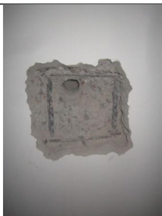
FOTOGRAFIA no. 45. Regata Columna eje B3 piso 2 bloque de patrulleros.
