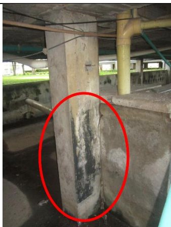
FOTOGRAFIA no 164. Humedad, eflorescencias, desprendimiento del concreto y acero con corrosión - columna eje G4 bloque administrativo.
