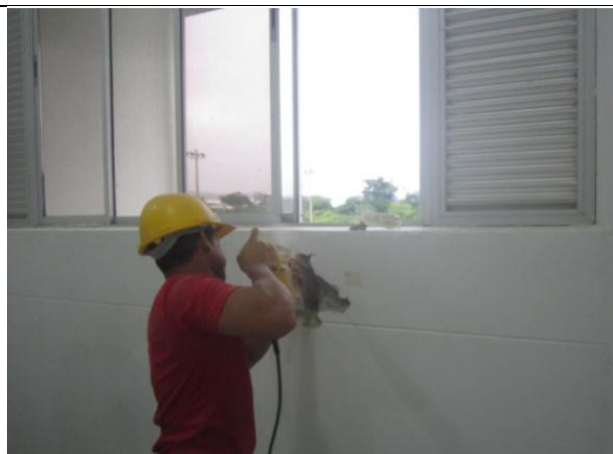
FOTOGRAFIA no. 27. Regata Viga eje B 10-11 piso 2 bloque de oficiales.
