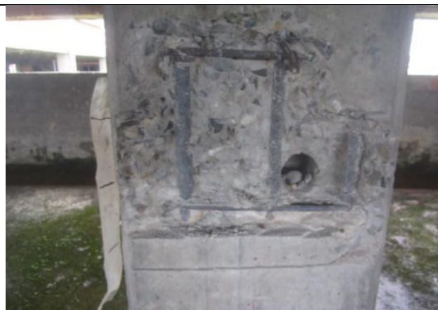
FOTOGRAFIA no. 36. Regata Columna eje C7 semisótano bloque de oficiales.
