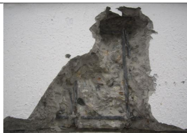
FOTOGRAFIA no. 38. Regata Viga entrepiso 1 Eje I-J bloque de oficiales.
