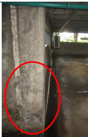
FOTOGRAFIA no 158. Desprendimiento del concreto y acero con corrosión - columna eje C3 bloque administrativo.
