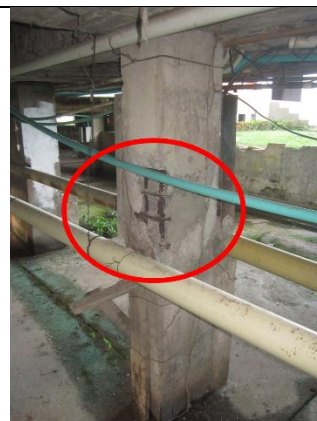
FOTOGRAFIA No. 163. Acero corroídos y desprendimiento del concreto - columna eje F4 bloque administrativo.
