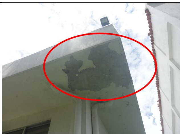
FOTOGRAFIA No 173. Daños por humedad y desprendimientos de pintura - bloque de oficiales.
