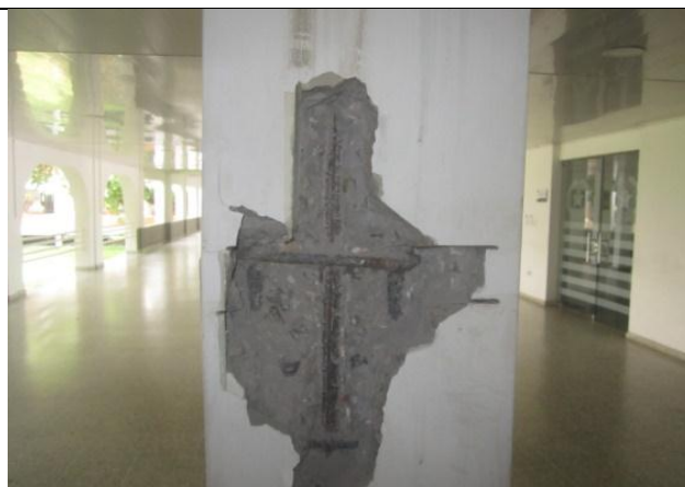
FOTOGRAFIA no 19. Regata Columna eje H-5i piso 1 zona administrativa 1.
