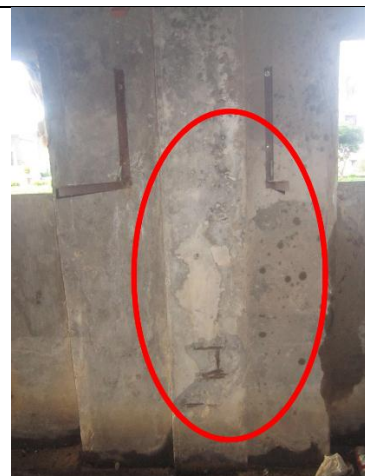
FOTOGRAFIA no 159. Desprendimiento del concreto y acero con corrosión - columna eje A2 bloque administrativo.
