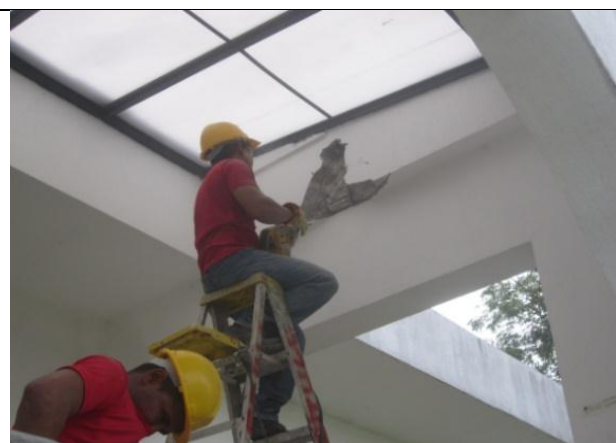
FOTOGRAFIA no. 37. Regata Viga entrepiso 1 Eje I-J bloque de oficiales.
