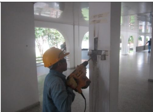
FOTOGRAFIA no 18. Regata Columna eje H-5i piso 1 zona administrativa 1.
