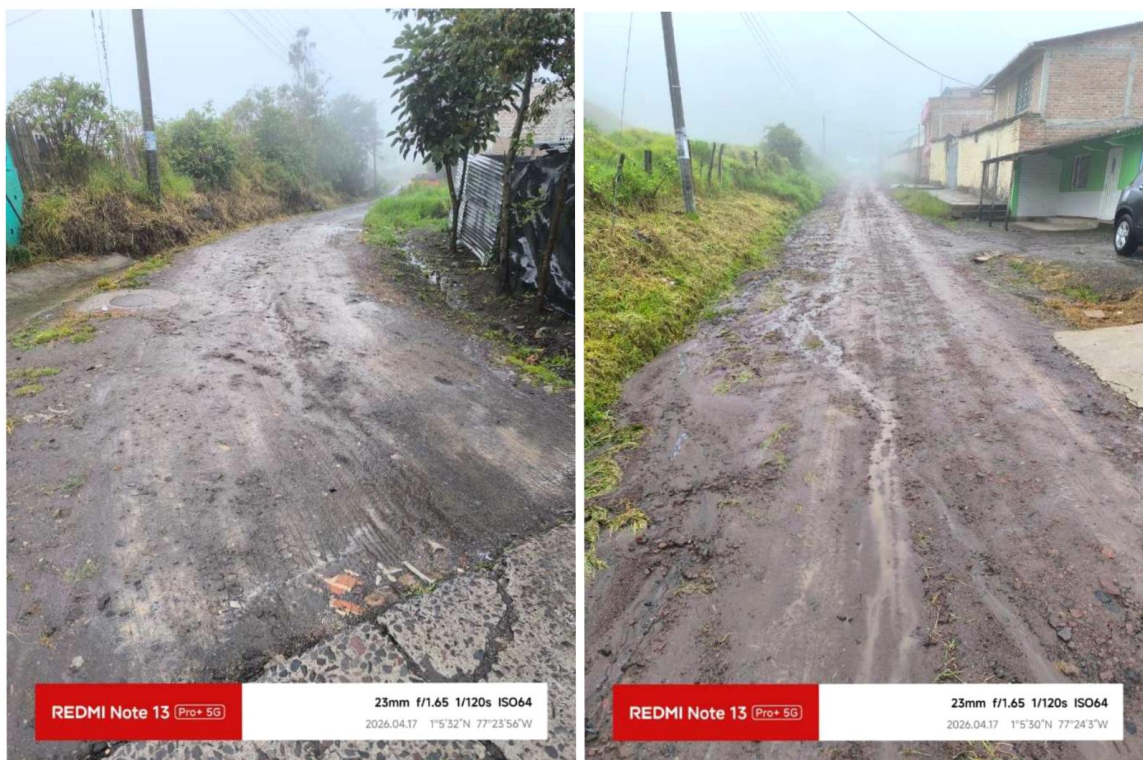
Condiciones actuales vía propuesta para intervención de mantenimiento vial.
