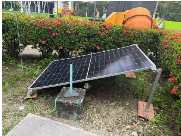
Imagen 11. Evaluación del sistema fotovoltaico de soporte energético instalado para la operación del equipo.
