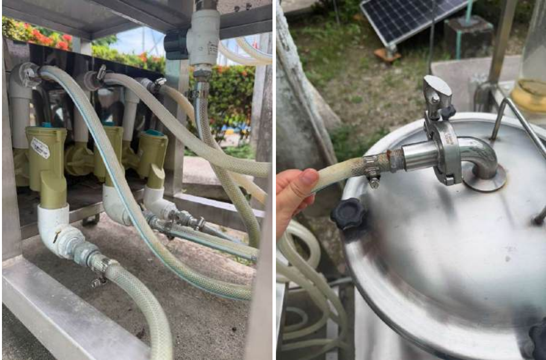
Imagen 10. Revisión de conexiones hidráulicas y puntos de acople del sistema de circulación del fotobiorreactor.
