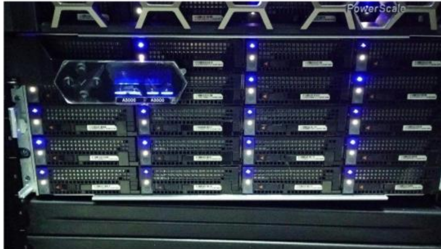
Ilustración 3 Registro fotográfico Visita diagnóstico Datacenter
