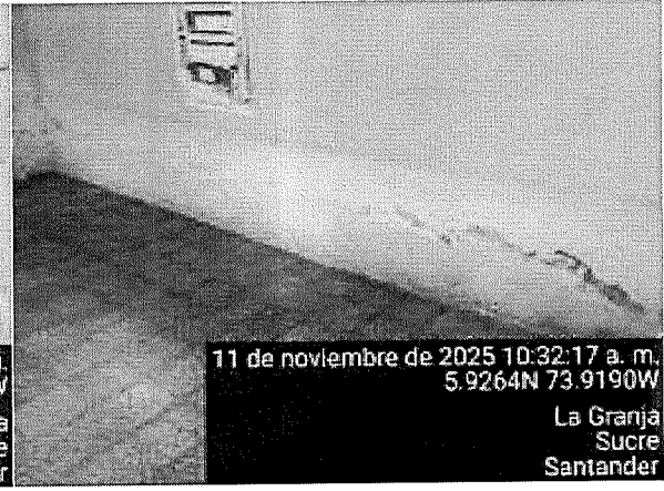
Imagen N.16 Desprendimiento de pintura en el área de distribución y consumo de alimentos
