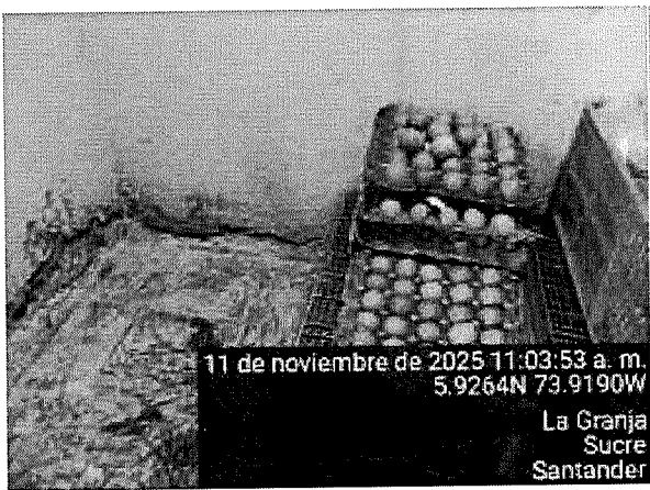
Imagen N.17 Desprendimiento de pintura en el área de almacenamiento de alimentos
