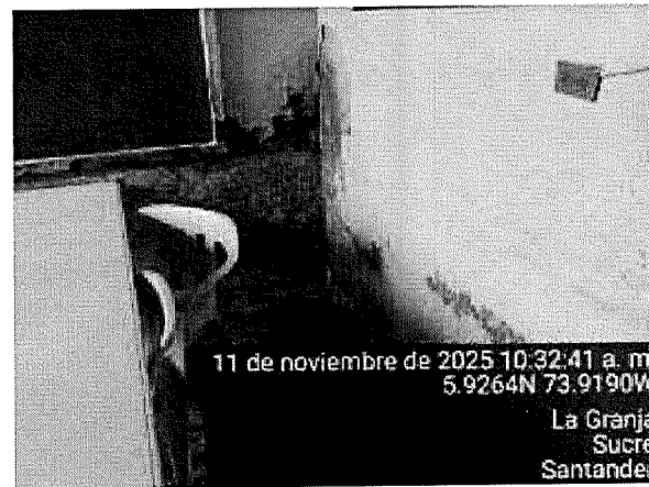
Imagen N.15 Desprendimiento de pintura en el área de distribución y consumo de alimentos
