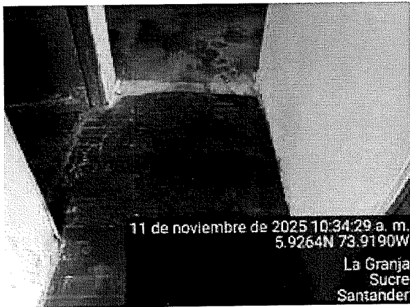
Imagen N.25 Acumulación de humedad en el piso de área de consumo.
