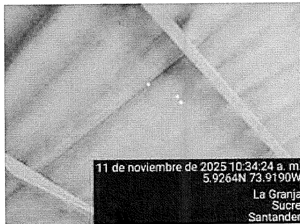
Imagen N.13 Techo en eternit con aberturas y grietas
