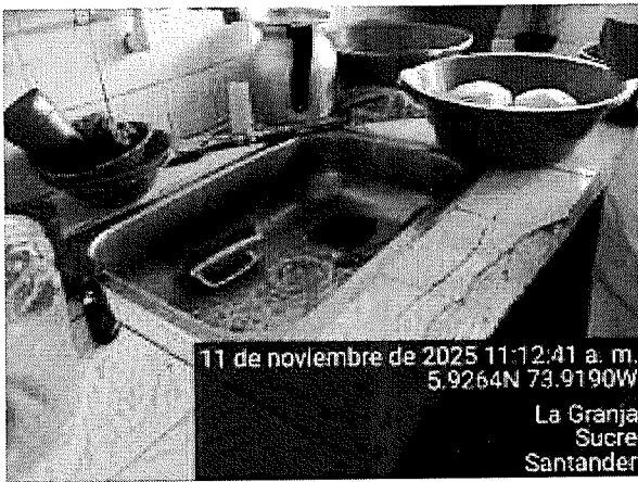
Imagen N.9 Lava platos con grietas y ausencia de baldosas.
