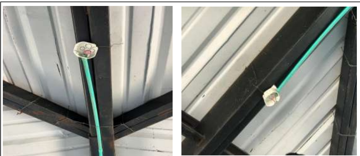
Foto1: los puntos eléctricos donde van las rosetas y los bombillos están deshabilitados y en uno de los casos los cables están deteriorados, por lo que no hay flujo de energía.
