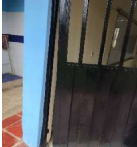
Foto1: La puerta se encuentra suelta de las bisagras, el cual no sirven y se deben soldar, también se debe nivelar.
