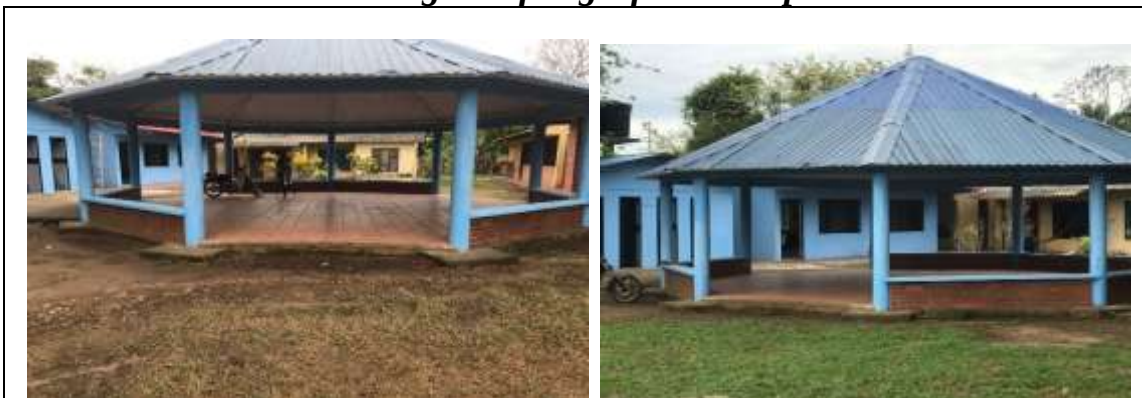
Foto 1: se puede evidenciar que el kiosco escolar esta sucio y descolorido, la pintura existente es de un tono amarillo donde en partes se evidencia la humedad.
