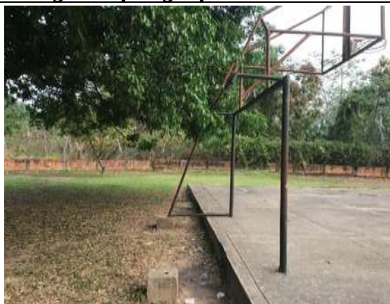
Foto 1: se puede apreciar que la cancha le hace falta el bajante derecho del marco y el tubo principal también está averiado por lo tanto se procede a corregir.
