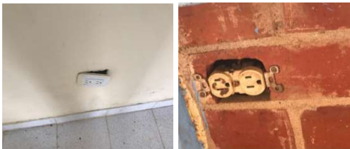
Foto 1: las tomas ya están averiados, sin tapas, algunos sin flujo de energía y otros deshabilitados el cual se le colocara las respectivas tapas.
