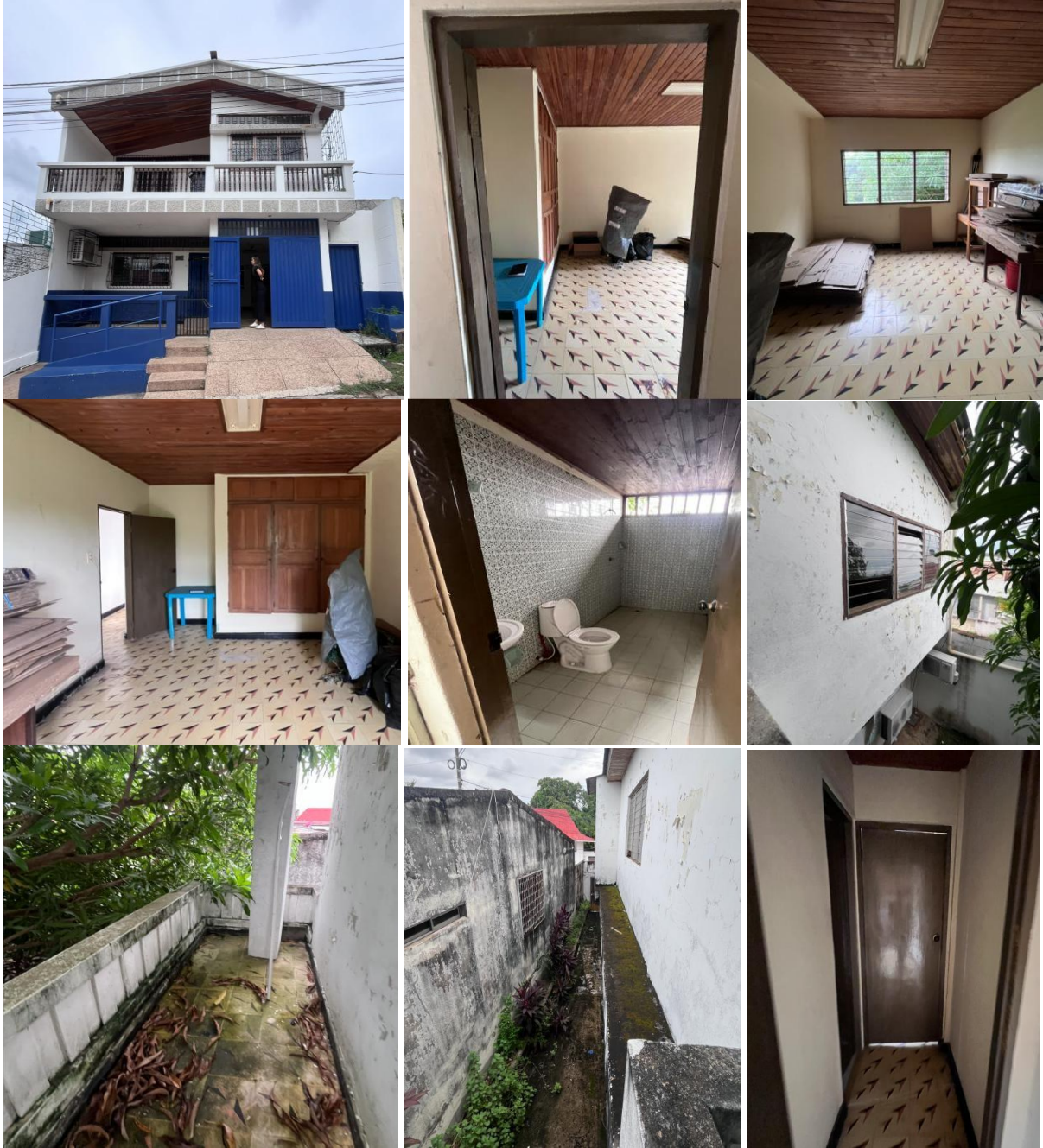
Imagen 2. Estado actual inmueble Registraduría Municipal de Since (Sucre).
