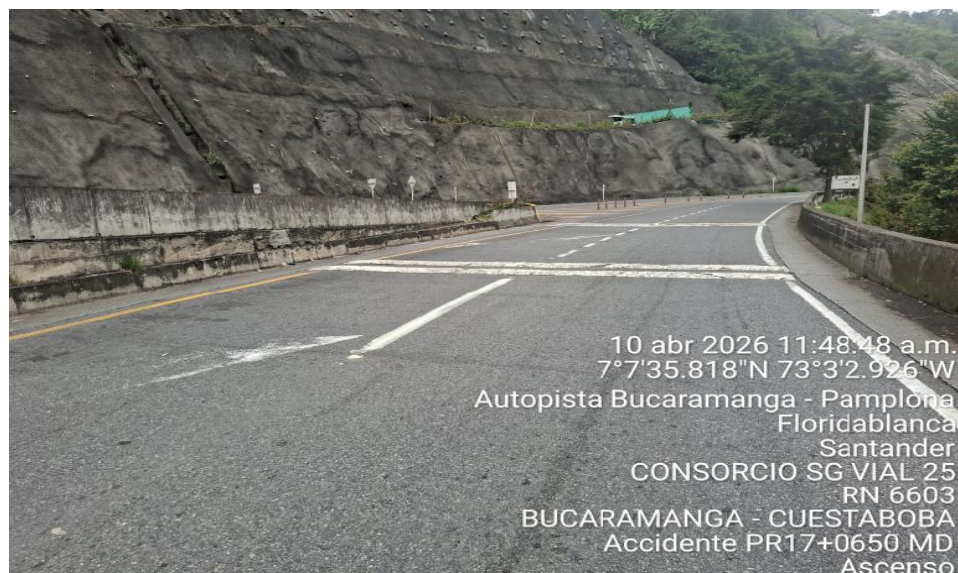
Fotografía, PR17+0650, Sentido Bucaramanga - Pamplona detalle del sitio del accidente
