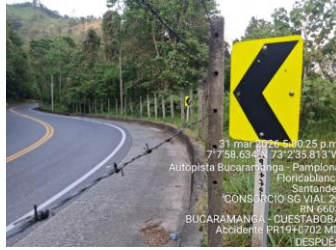
SEÑAL SP 75 PR19+0702 MARGEN DERECHA FECHA INST.
