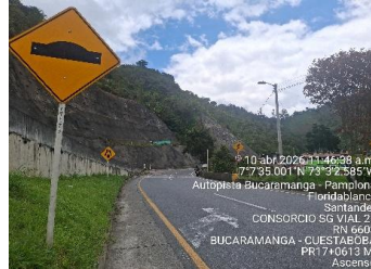
SEÑAL SP 25 PR17+0613 MARGEN IZQUIERDO FECHA INST.
