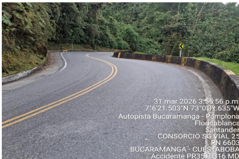
Fotografía, PR35+0316, Sentido Bucaramanga - Pamplona detalle del sitio del accidente
