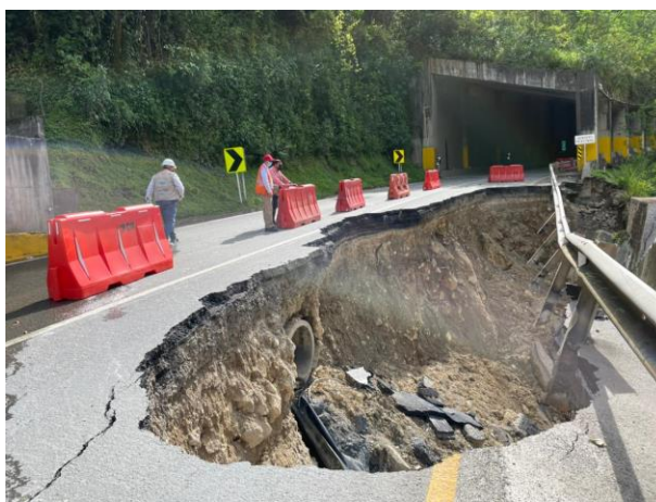
Inspección de afectación y control provisional en recorrido técnico del 30 de marzo de 2023.
