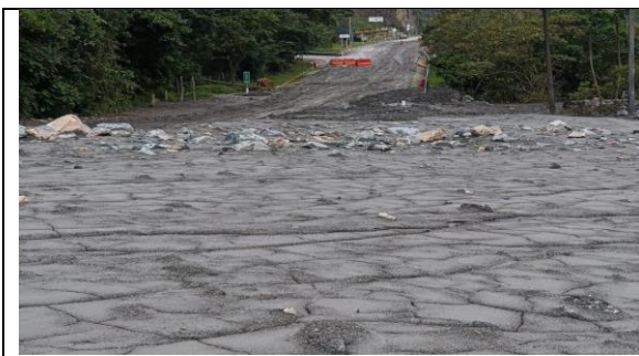
Imagen No. 11: Acumulación de material por precipitaciones
