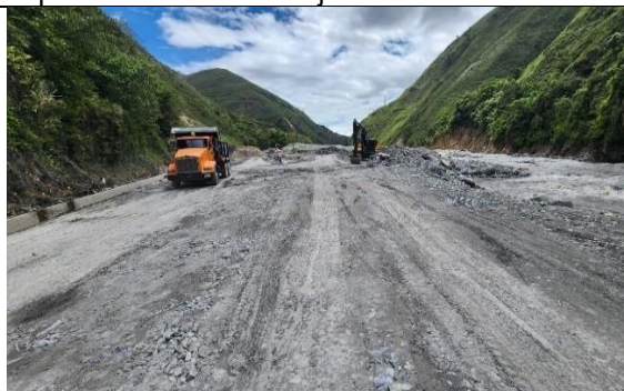
Imagen No. 8: Despeje de vía sentido Villavicencio - Bogotá
