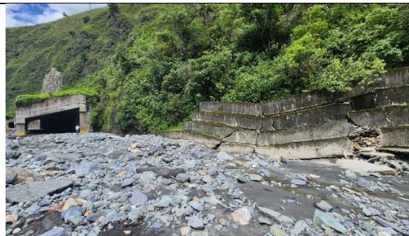
Imagen No. 5: Condición Inicial (Previo Intervenciones)
