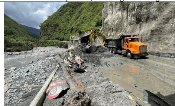
Imagen No. 7: Despeje de vía sentido Villavicencio - Bogotá
