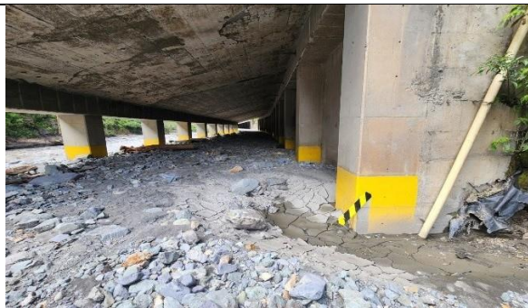
Imagen No. 6: Condición Inicial (Previo Intervenciones)
