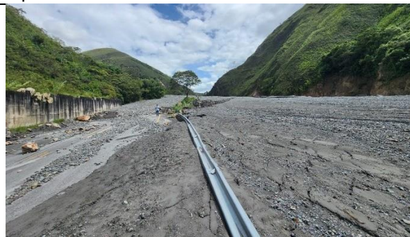
Imagen No. 3: Condición Inicial (Previo Intervenciones)
