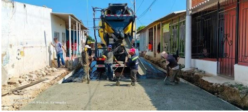
CALLE 97 ENTRE CARRERAS 8 Y 8C - LAS MALVINA- Módulo 2
