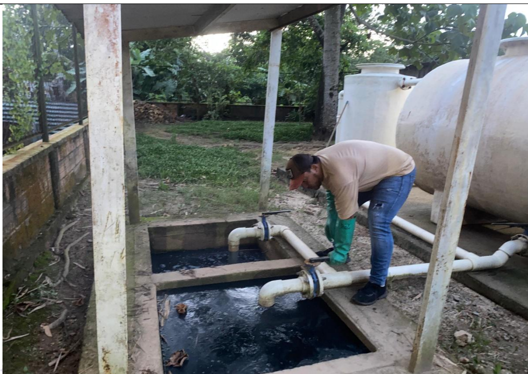
purga de lodo (tanque de aireación, sedimentador).
