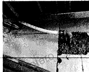
Ilustración: Manguera nueva del autoservicio
