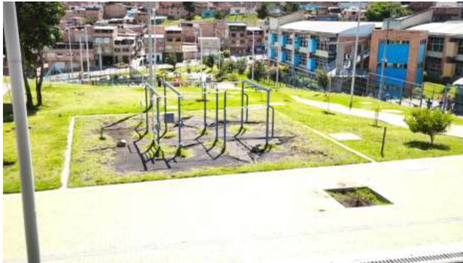
Foto # 4. Mantenimiento al área de multi fuerza se encuentra en mal estado.
