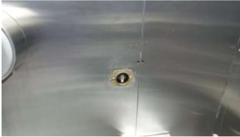
Foto # 1 . Phus en mal estado de los orinales y los sanitarios
