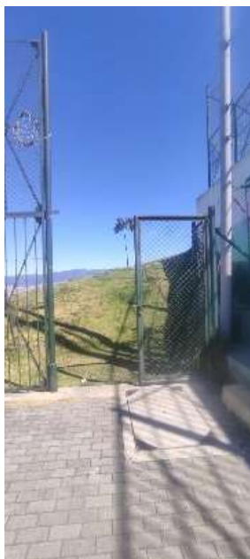
Foto # 8 Puerta de la cancha # 1 está deteriorada
