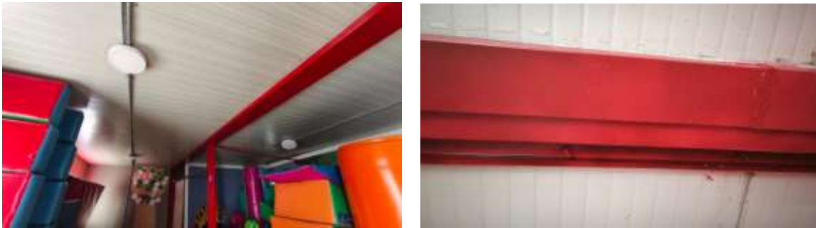
Foto # 18. Mantenimiento en la ludoteca las bombillas están en mal estado y tenemos una fuga de agua cuando llueve sobre las instalaciones.
