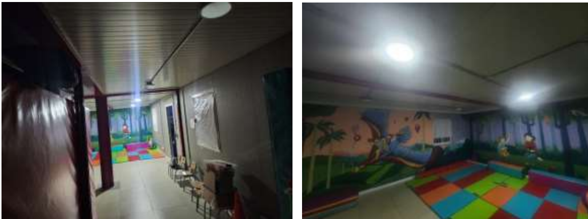
Foto # 19. Mantenimiento en la ludoteca las bombillas están en mal estado y tenemos una fuga de agua cuando llueve sobre las instalaciones.
