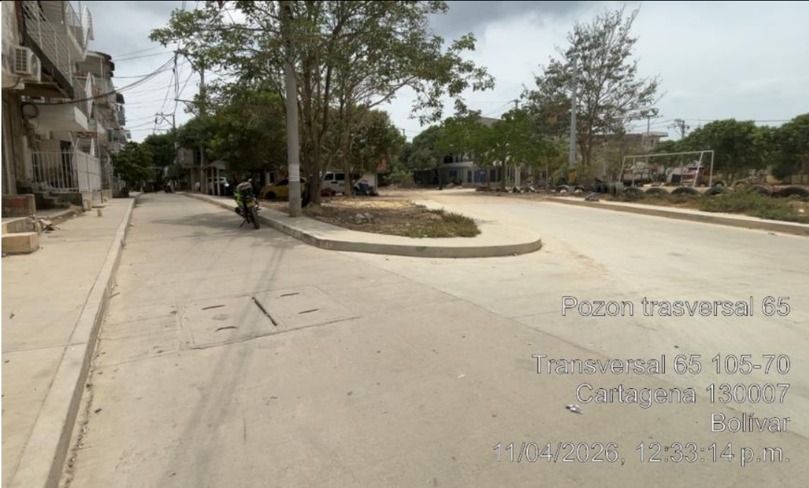
Estado del pavimento en operación.
