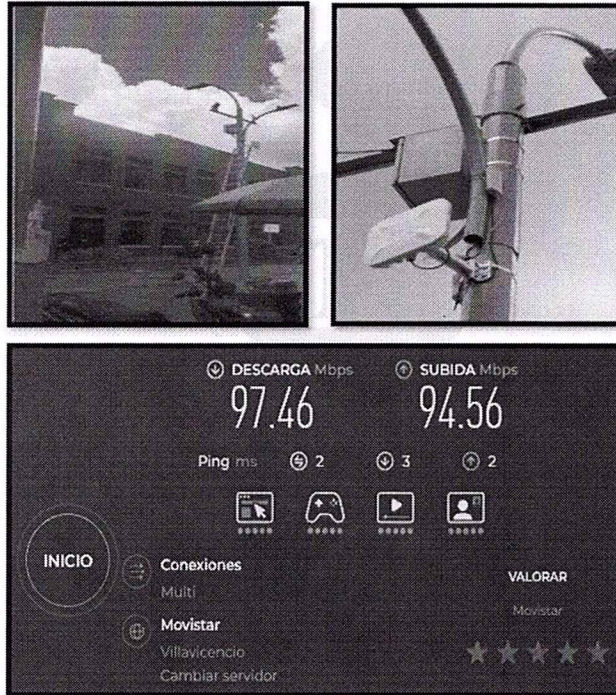
Imagen 03. Instalación, Test de Velocidad y Latencia según los estándares requeridos. Parque Central
