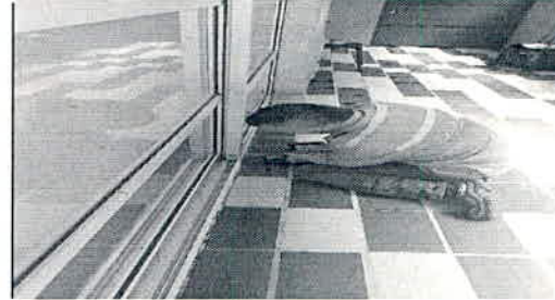
Descripción: Reparación puerta CEC San Marcos
