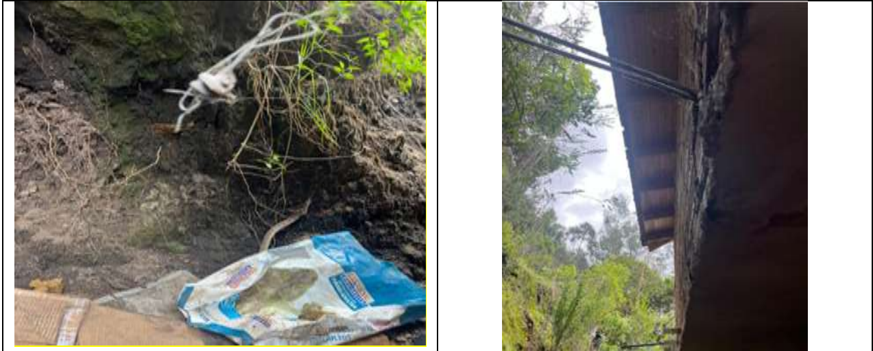
Ilustración del talud y su cercanía a la vivienda. Se detalla la composición del suelo, corroborando un suelo orgánico que es susceptible de pasar a estado erodable por saturación excesiva.
