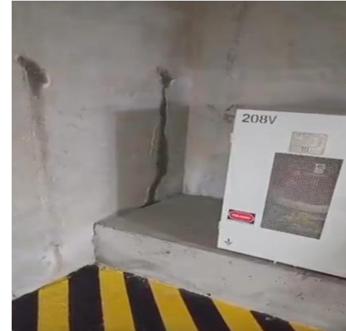
FILTRACIONES PISCINA RECREATIVA EN ZONA SUBTERRANEA
