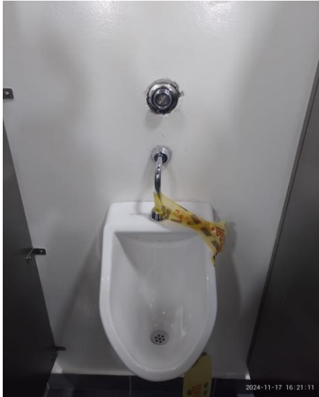
ORINAL GENERANDO FUGA
