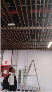
Seguimiento arreglo gotera lobby, daño en batería de baños públicos
