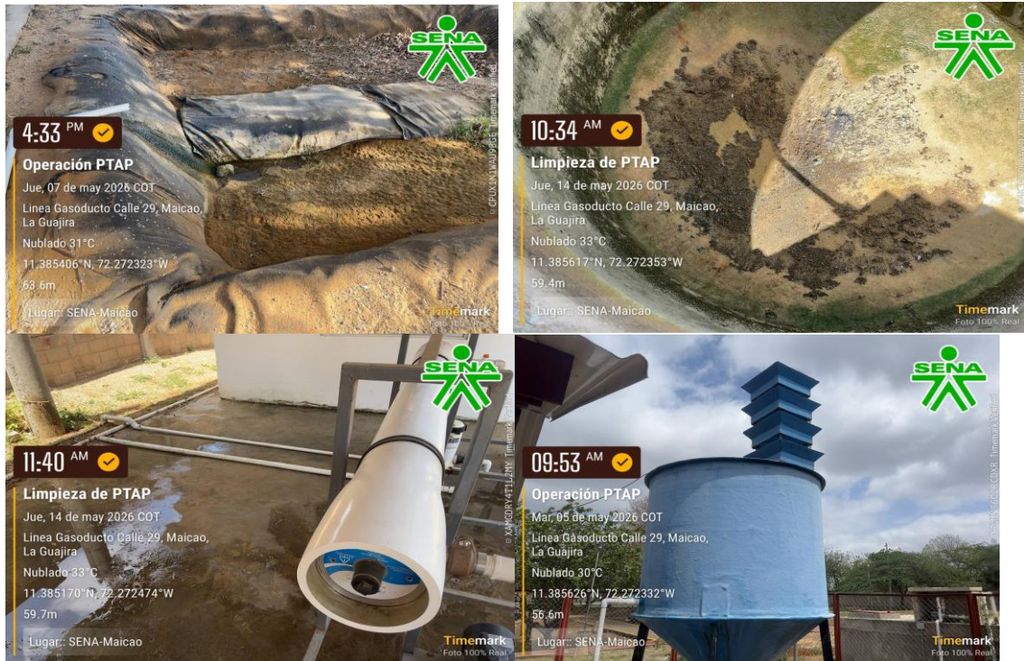
imagen1. Operación de PTAP y verificación de niveles de agua.
