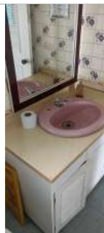
32. Baño área administrativa antes, llave no ahorradora y mueble en malas condiciones.
