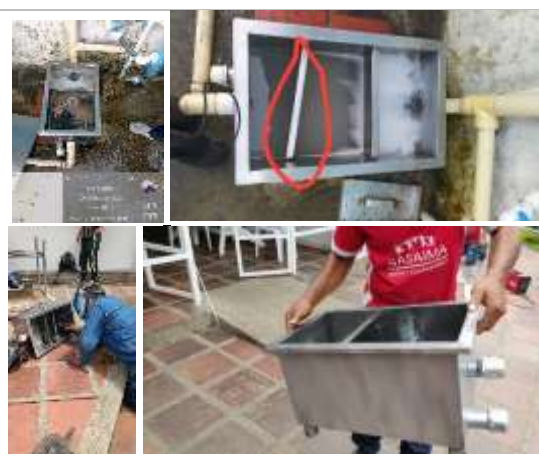
Figura 16. Trampa de grasas antes y después
