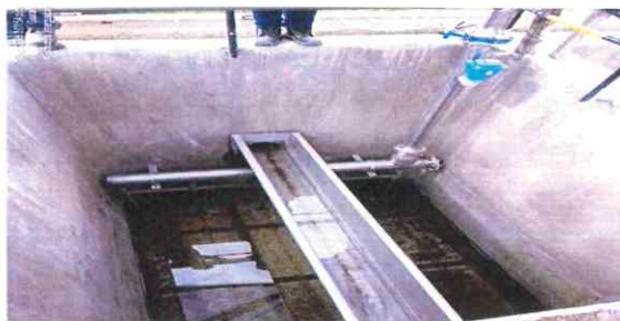
ESTADO INICAL DE FILTRACION MODULO B PTAP GUACARI
