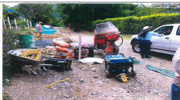
MATERIALES CONSTRUCCION CAMARAS DE VENTOSA TRAMO 3 COMPRENDE CADICA A PTAP GUACARI
