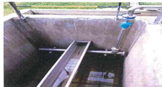
ESTADO INICAL DE FILTRACION MODULO B PTAP GUACARI
