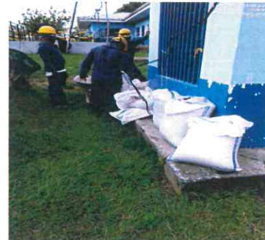
MATERIAL DE FILTRALITE PARA SU COLOCACION EN MODULO DE FILTRACION B PTAP GUACARI
