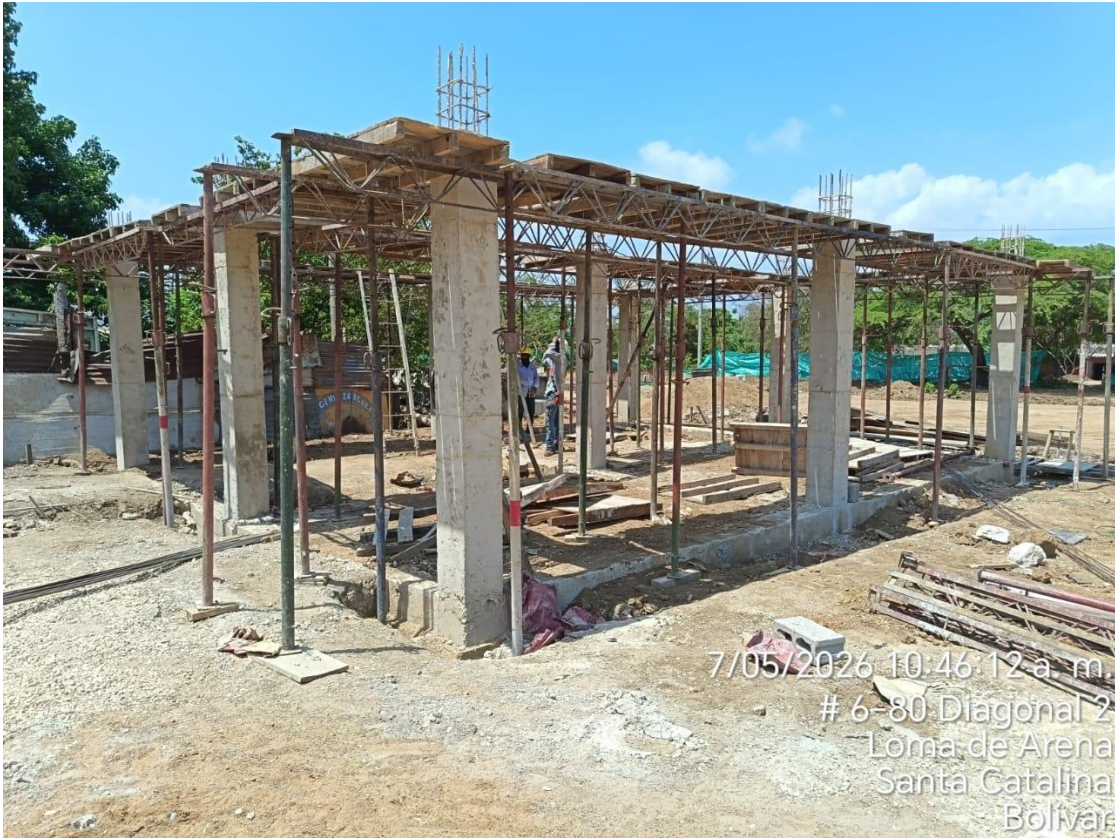
Fotografía 2. Subestación Eléctrica Equipamiento 1 – 07/05/2026
