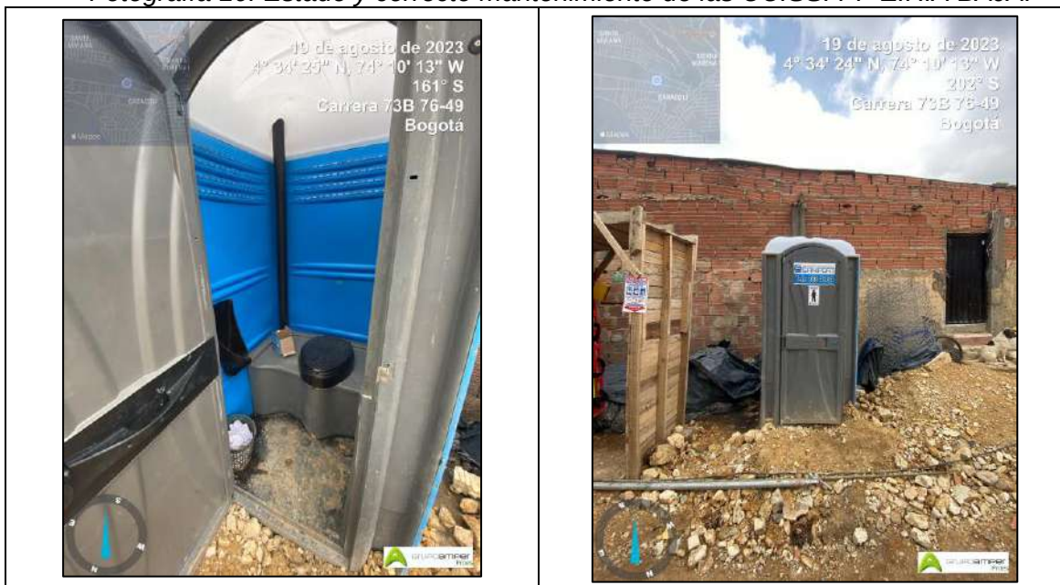
Fotografía 10. Estado y correcto mantenimiento de las UU.SS. PP Z.R.A BAJA.
