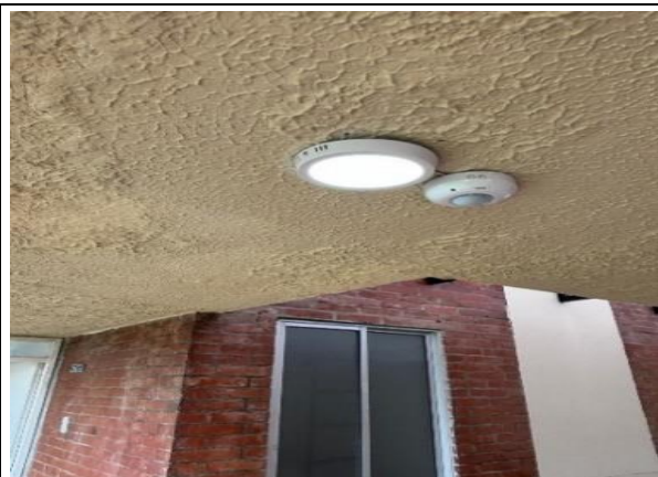
INSTALACIONES ELECTRICAS ZONA COMUN
