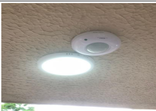
INSTALACIONES ELECTRICAS ZONA COMUN
