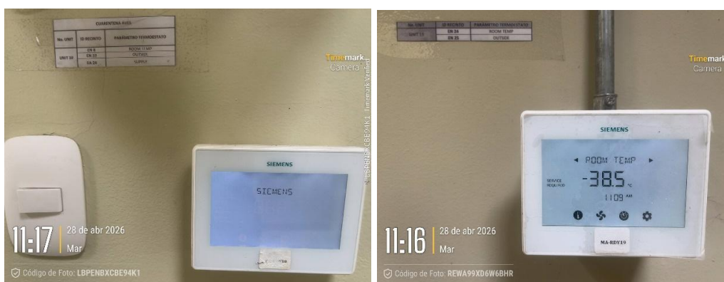
Foto 42-43. Fallas en pantallas de registro de temperatura
