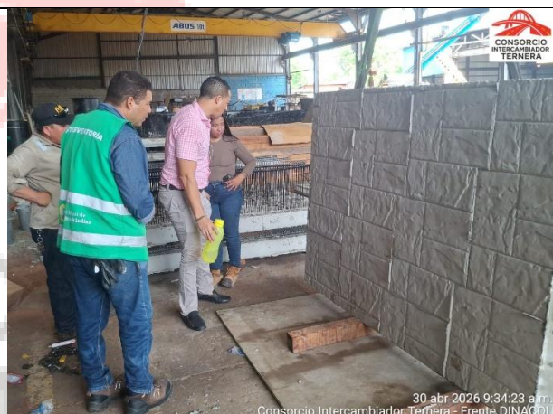
Ilustración 28. Visita de asesor estructural de interventoría evaluación de observaciones en paneles de concreto texturizados – 30 de abril de 2025.
