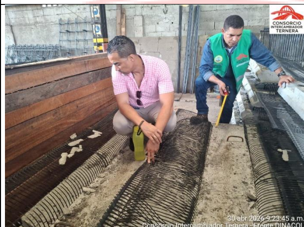
Ilustración 27. Visita de asesor estructural de interventoría evaluación de observaciones en paneles de concreto texturizados – 30 de abril de 2025.
