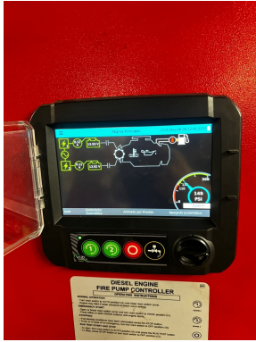
Controlador principal - presión del sistema durante prueba
