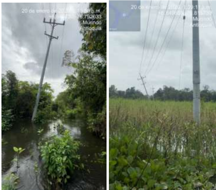
Ilustración 6. Inclinaciones fuera de tolerancia en los apoyos y proximidad de vegetación a conductores energizados.
